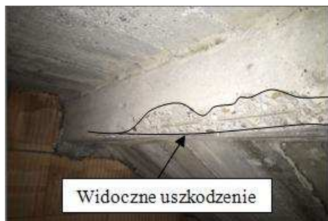
Rys. 2. Widok istniejącego uszkodzenia w dolnej części belki spocznikowej
