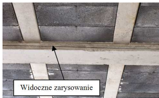
Rys. 3. Widok istniejącego zarysowania w wewnętrznym podciągu żelbetowym
