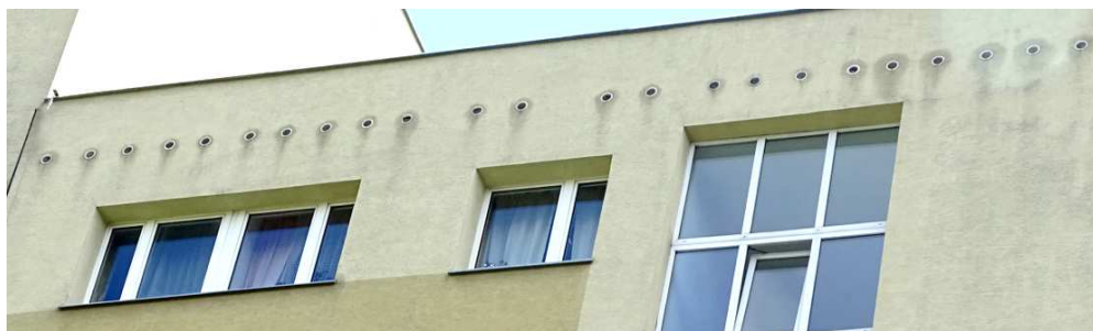
Rys. 11. Kondensacja pary wodnej w okolicach wylotów kanałów wentylacyjnych (2016)
