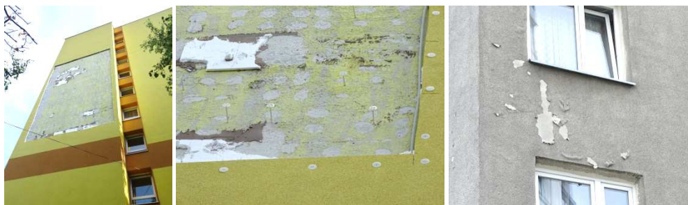
Rys. 9. Uszkodzenia systemów ETICS (2016)
