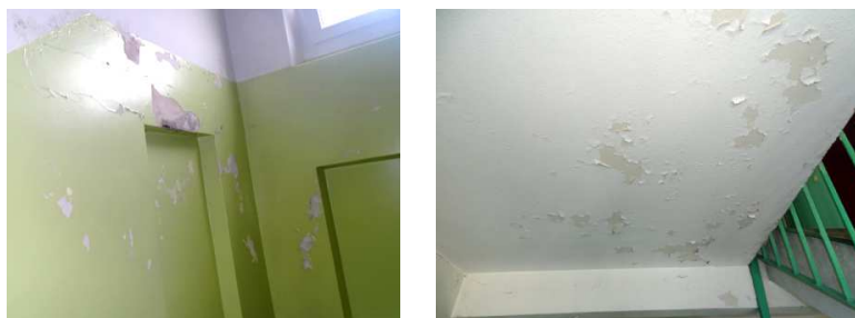
Rys. 13. Uszkodzenia powłok na klatkach schodowych (2016)
