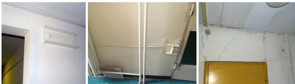
Rys. 6. Budynek ze wzmocnieniami i bliźniaczy z licznymi zarysowaniami (2016)
