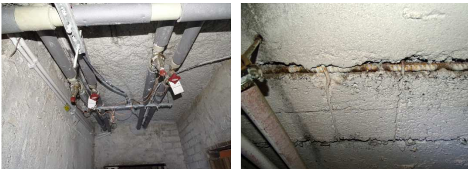
Rys. 4. Ocieplenie stropu i strop z odkrytym zbrojeniem pomalowanym farbą z gipsem (2016)
