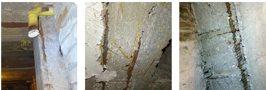
Rys. 5. Brak korozji na części powierzchni zbrojenia (2016)
