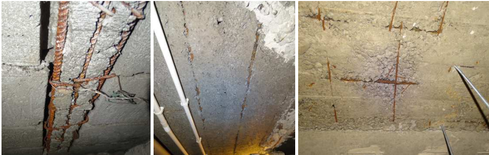
Rys. 2. Fragmenty zbrojenia nie zabezpieczone od momentu wybudowania (2016)
