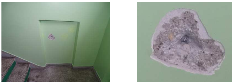
Rys. 8. Kruche wyłamanie betonu prefabrykatu
