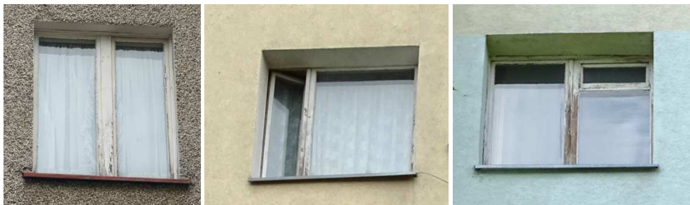
Rys. 12. Przykłady stolarki okiennej ze złuszczącymi się powłokami farby(2016)
