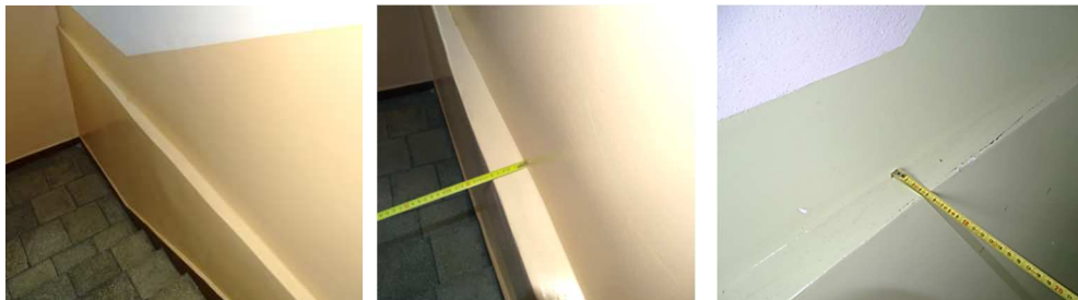
Rys. 1. Nie osiowy i nierównoległy montaż płyt widoczny na klatkach schodowych (2016)
