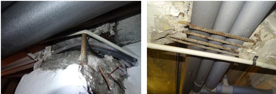
Rys. 3. Fragmenty zbrojenia odsłonięte przy pracach instalacyjnych i nie zabezpieczone (2016)
