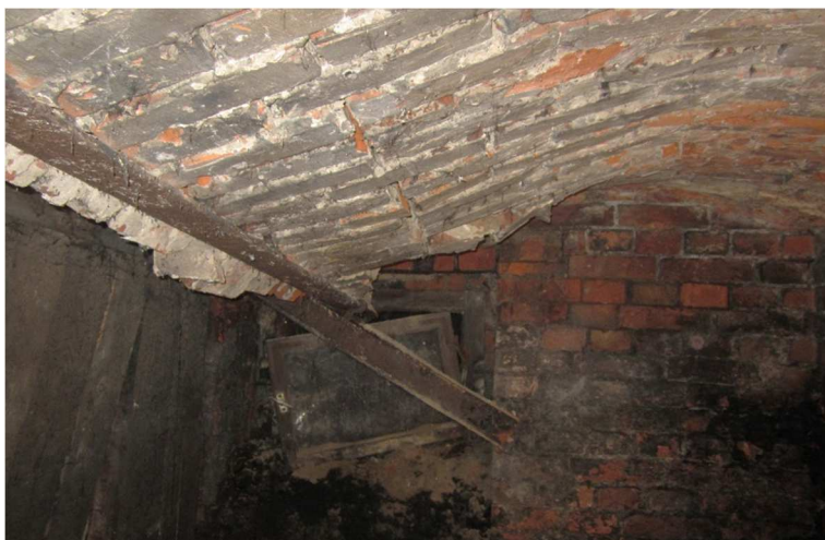
Rys. 6. Częściowo zawalone sklepienie
