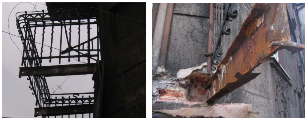
Rys. 9. Katastrofa budowlana balkonu (marzec 2009 r.)
