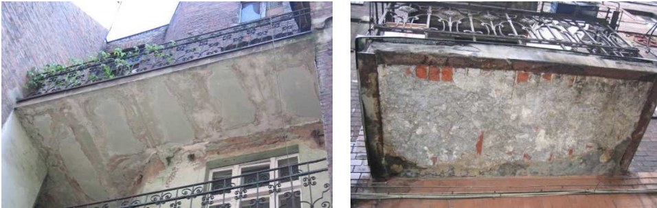
Rys. 7. Przecieki przez płytę balkonu w okolicy stalowych belek nośnych (z lewej) oraz uszkodzenia korozyjne belek i mrozowe płyty ceramicznej i wypraw tynkarskich (z prawej)
