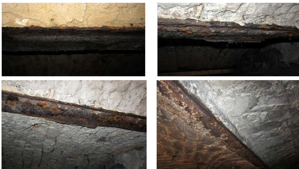
Rys. 5. Przykłady uszkodzeń korozyjnych belek stropów odcinkowych
