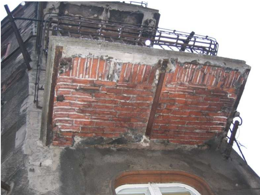
Rys. 8. Zły stan techniczny balkonu (styczeń 2006 r.) – widoczne uszkodzenia i odspojenia cegieł dziurawek do poziomu pierwszego rzędu otworów, zły stan belek stalowych
