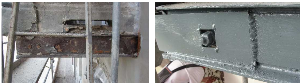
Rys. 14. Belka wspornikowa balonu przed i po wzmocnieniu
