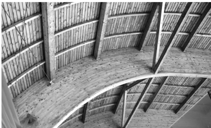
Rys. 5. Widok przebarwień od spodu zadaszenia
