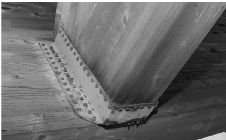
Rys. 8. Widoczna korozja główek gwoździ oraz powierzchni łącznika stalowego
