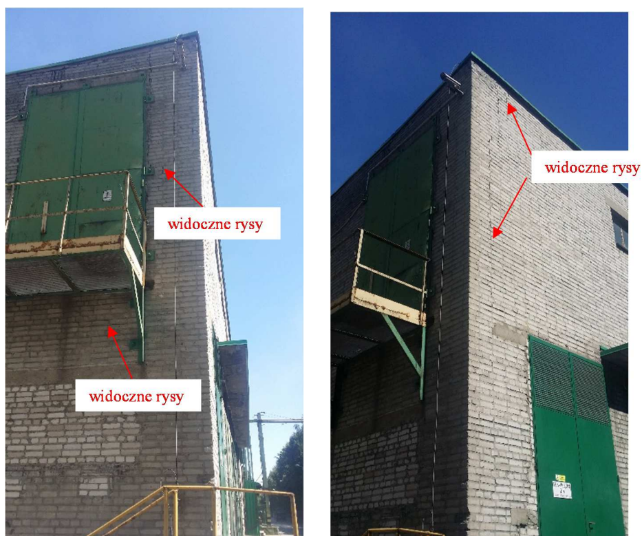
Rys. 6, 7. Zachodni narożnik budynku – widoczne spękania biegnące przez całą wysokość kondygnacji I piętra
