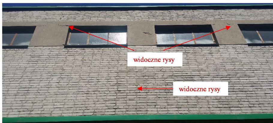
Rys. 8. Elewacja południowa – widoczne spękania pionowe, spękania w okolicach podparcia belek nadprożowych i spękania nad otworami okiennymi
