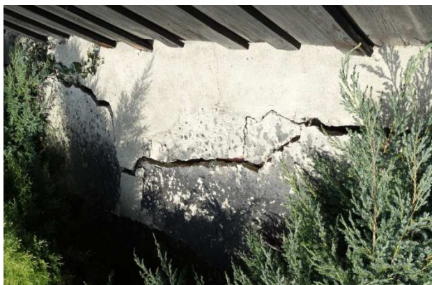
Rys. 12. Zniszczenie podmurówki przy osiadającym narożu
