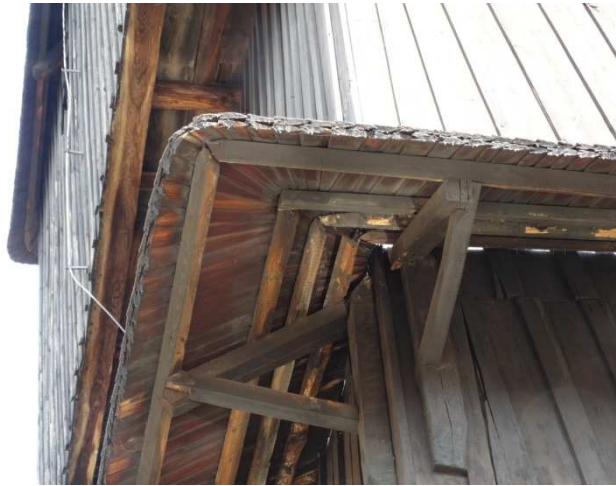
Rys. 10. Przykład uszkodzeń konstrukcji daszku pośredniego
