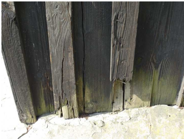
Rys. 11. Przykład uszkodzeń elementów szalowania ścian
