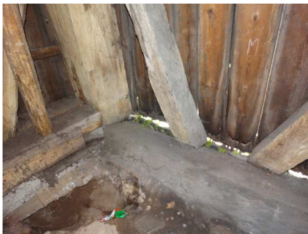
Rys. 7. Uszkodzone elementy konstrukcyjne w południowo-zachodnim narożu wieży
