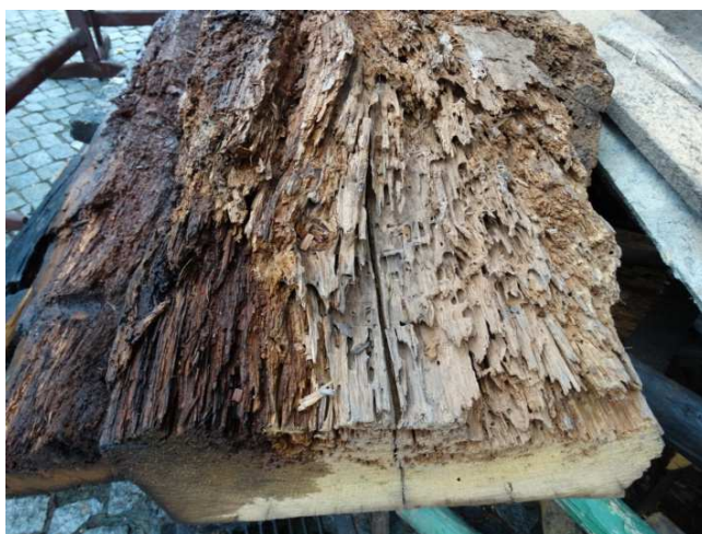
Rys. 9. Stan techniczny belki podwalinowej – widok po demontażu jesienią 2016 r.
