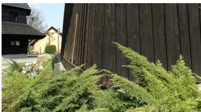
Rys. 8. Deformacja ściany zachodniej
