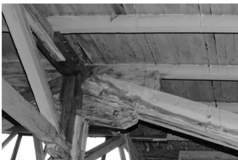
Rys. 8. Widok uszkodzonego węzła
