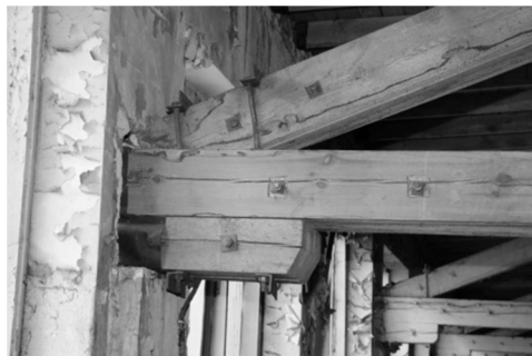
Rys. 12. Niewłaściwa naprawa węzła podporowego
