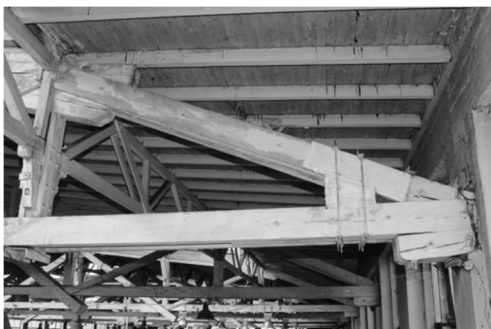
Rys. 10. Uszkodzenie w miejscu naprawy węzła podporowego
