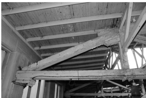
Rys. 7. Widok skorodowanego ściągu
