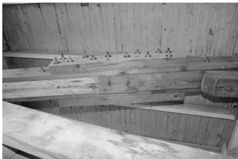
Rys. 11. Niewłaściwa naprawa ukośnego elementu pasa górnego
