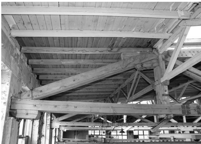
Rys. 6. Widoczne naprawy wykonane w ostatniej dekadzie
