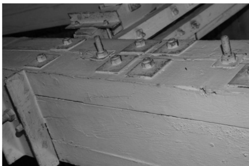
Rys. 9. Pęknięcie ukośne elementu rozciąganego dwugłazowego pasa dolnego
