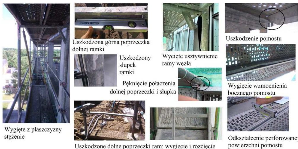
Rys. 10. Przykłady uszkodzeń elementów rusztowań, wpływających na nośność konstrukcji
