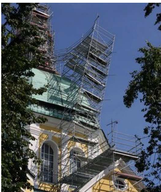
Rys. 2. Zniszczone rusztowanie modułowe
