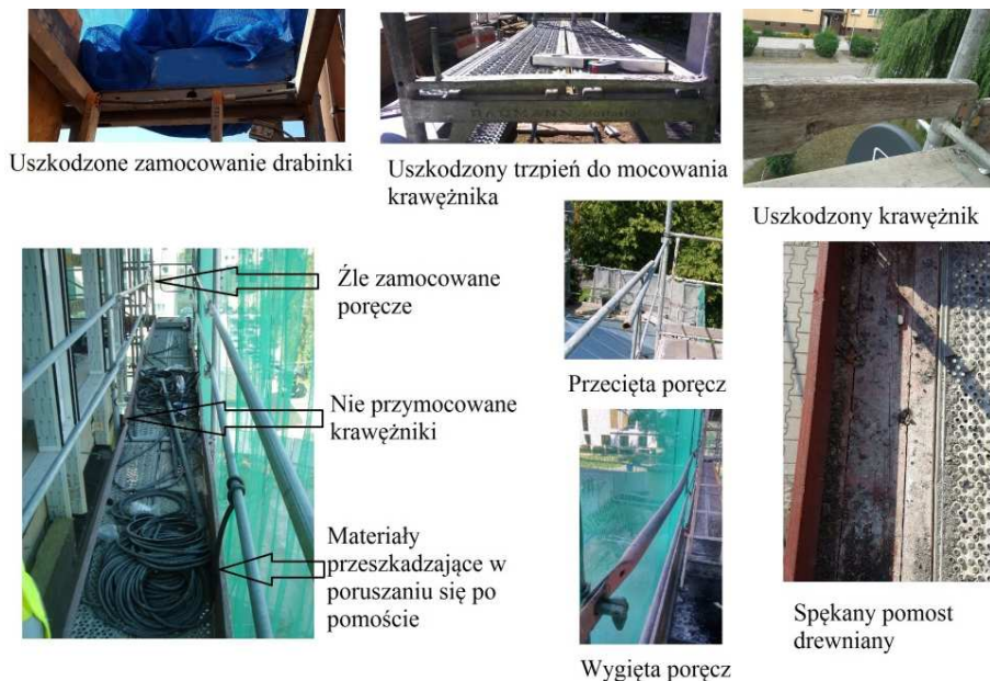
Rys. 11. Przykłady uszkodzeń elementów rusztowań, wpływających głównie na bezpieczeństwo pracowników
