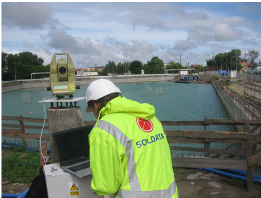
Rys. 3. Instalacja systemu Cyclop
