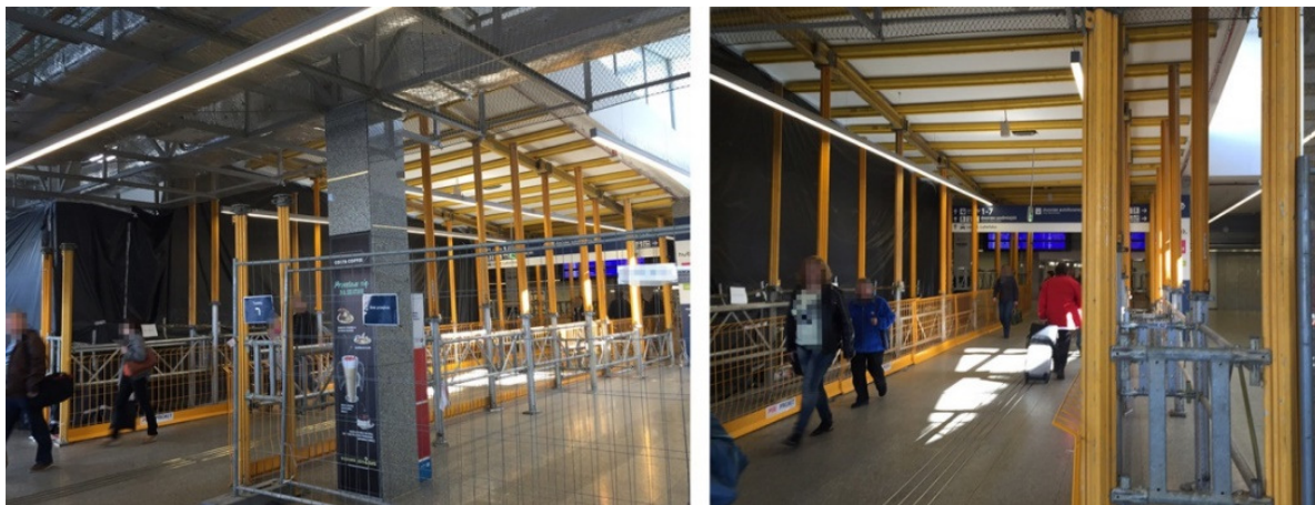
Rys. 18 Daszek zabezpieczający przejście dla pieszych
