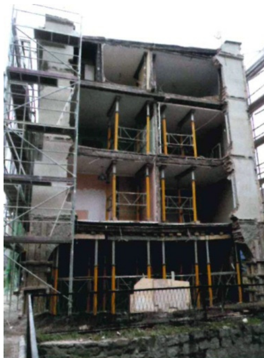
Rys. 16 Podparcie zabezpieczające stropów po wystąpieniu katastrofy [9]
