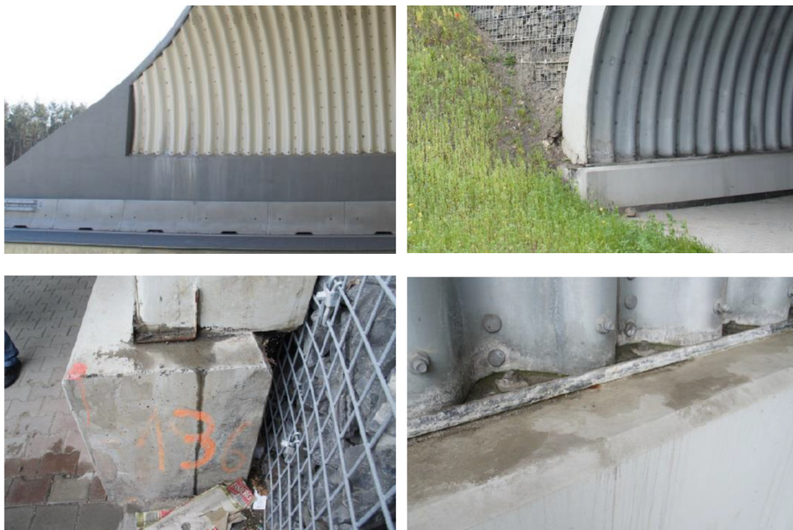
Rys. 2. Przykłady zacieków konstrukcji z blach falistych w strefie podporowej
