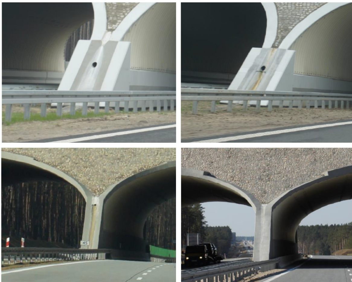
Rys. 3. Przykłady zacieków ścian czołowych w obrębie podpory środkowej mostów ekologicznych. Zacieki występują pomimo zastosowania drenażu
