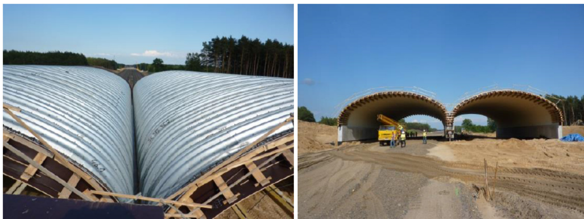
Rys. 5 Most ekologiczny nad autostradą w trakcie realizacji. Widoczne miejsca stykających się w części środkowej dwóch „szczelnych” konstrukcji. Widoczne jest newralgiczne miejsce, którego właściwe odwodnienie powinno być „szczególną troską” projektanta i wykonawcy
