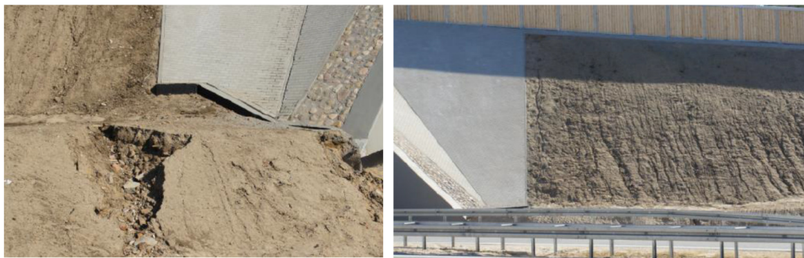
Rys. 4. Przykłady erozji skarp i rowów w obrębie posadowienia
