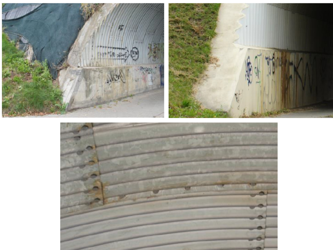
Rys. 7. Przykłady początkowego stadium korozji konstrukcji z blach falistych wywołanej przenikaniem wody w strefie nadpodporowej (górne zdjęcia fotograficzne). Korozja na skutek przecieków w części górnej powłoki metalowej – w obrębie klucza (zdjęcie fotograficzne obok)
