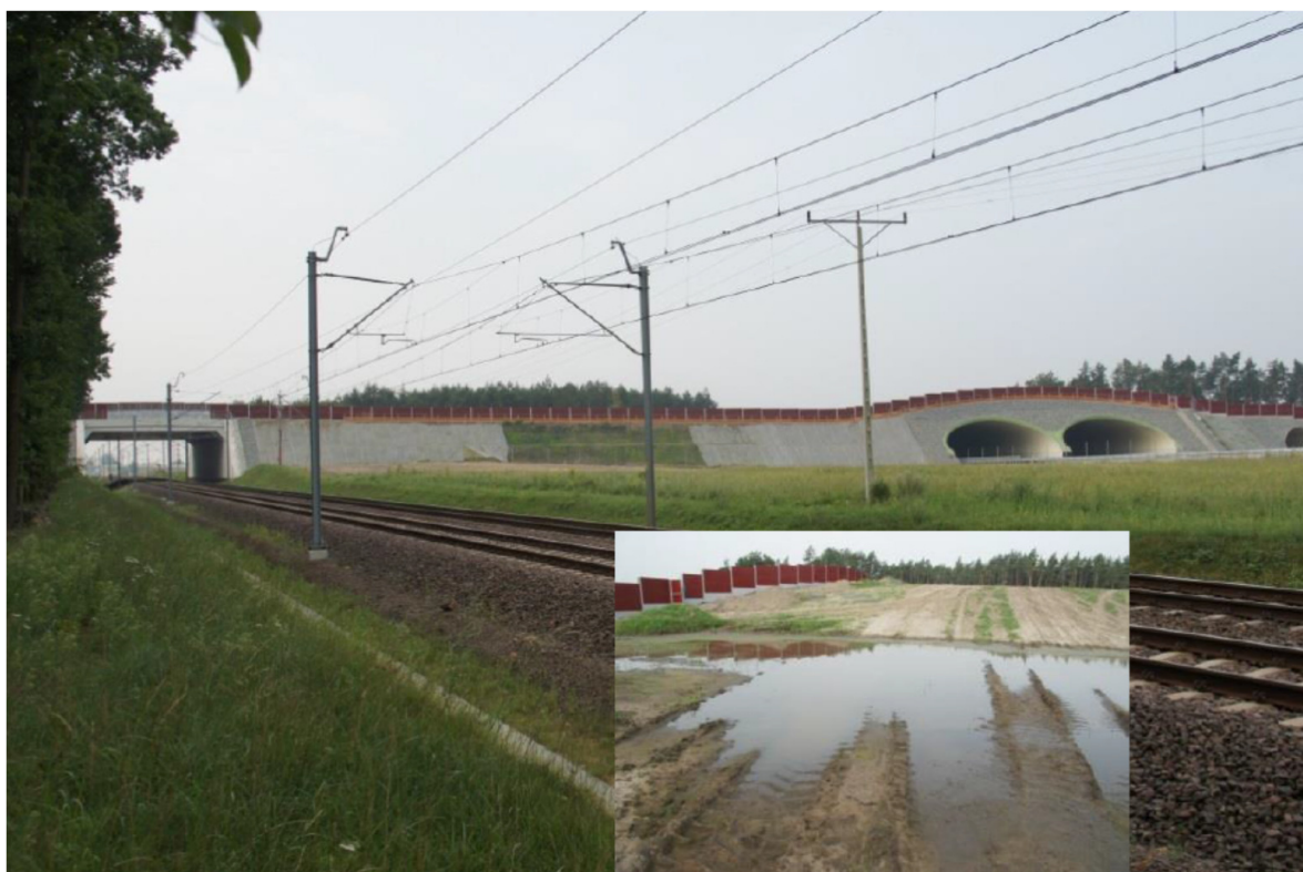
Rys. 6 Problem i skala właściwego odwodnienia powierzchniowego dla mostu ekologicznego nad magistralną linią kolejową i jednocześnie nad drogą szybkiego ruchu
