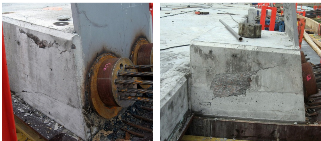
Rys. 5. Wsporniki poprzeczne z uszkodzeniami po sprężeniu kablami
