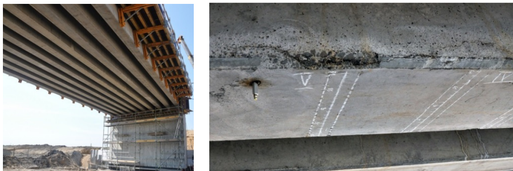
Rys. 8. Widok obiektu oraz uszkodzony fragment belki podlegający diagnostyce ultradźwiękowej
