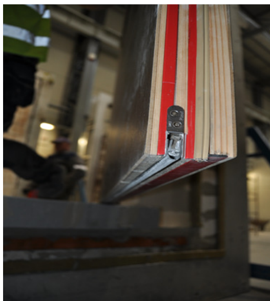
Rys. 2. Widok uszczelek pęczniejących czerwone i opadającej w dolnej krawędzi skrzydła
