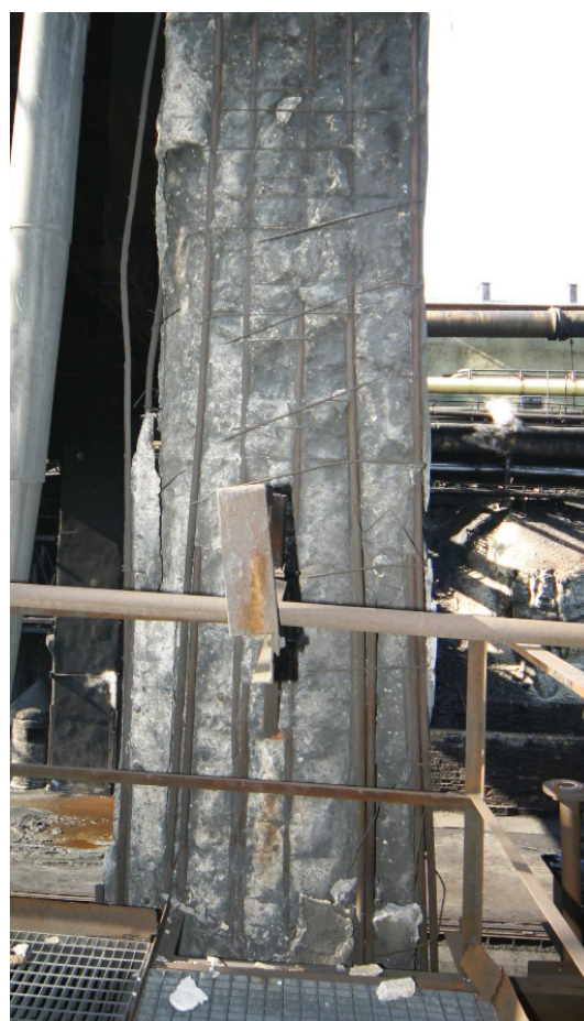
Rys. 3. Uszkodzenia słupów żelbetowych: ubytki otuliny betonowej, zaawansowana korozja zbrojenia, odspojenia zbrojenia głównego od betonu, całkowite zniszczenia strzemion
