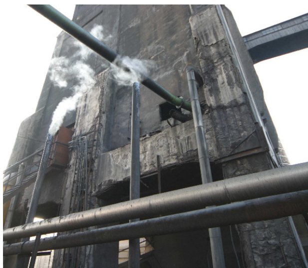
Rys. 2. Zły stan zachowania elementów żelbetowych wieży węglowej
