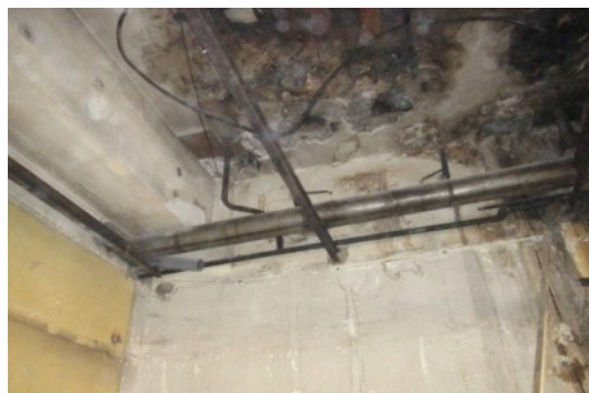
Rys. 4. Ubytek otuliny, widoczne zbrojenie nośne i strefa głębokiej penetracji korozji
