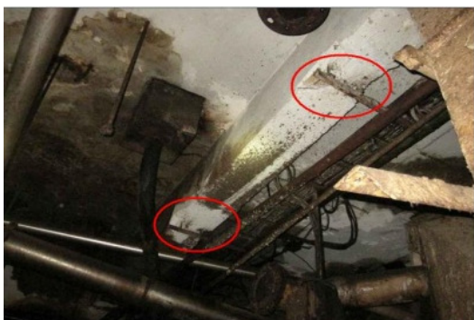
Rys. 3. Widoczne ubytki otuliny spowodowane odkuciem, w celu podwieszenia instalacji
