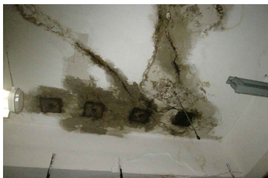
Rys. 6. Zawilgocenia i pęknięcia płyty stropowej (widoczne blachy kotew mocujących)
