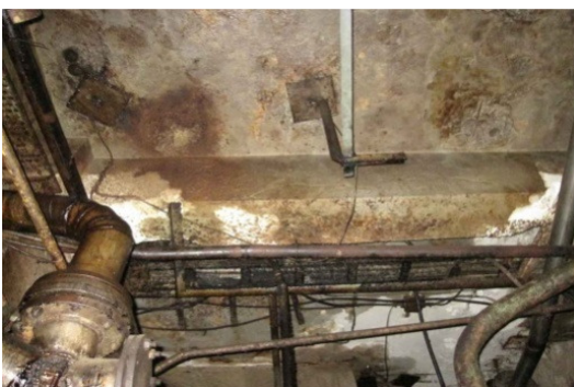
Rys. 5. Zawilgocenie płyty stropowej i żebra
