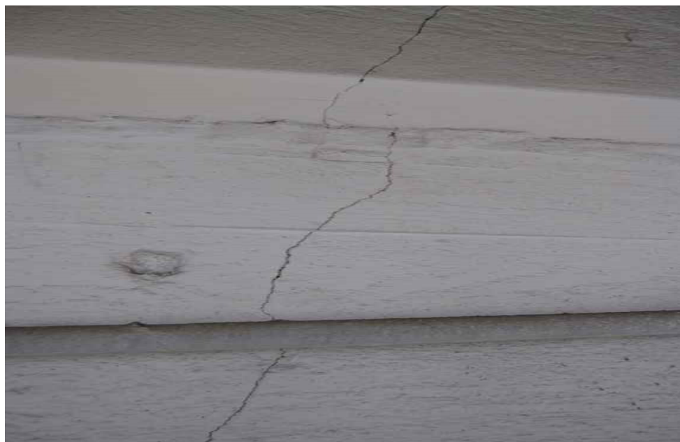
Rys. 7. Widoczne zarysowania jednego z podciągów
