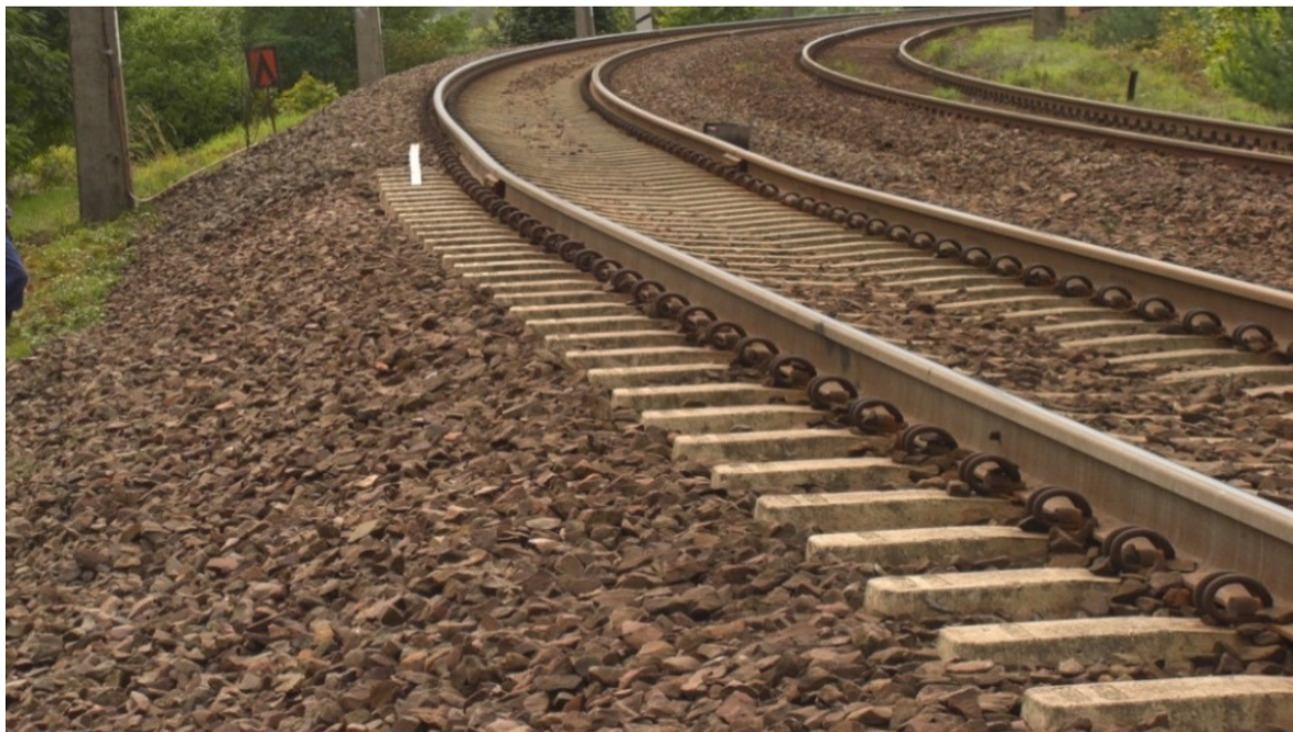
Rys. 2. Nieobsypane czoła podkładów, brak ławy torowiska
