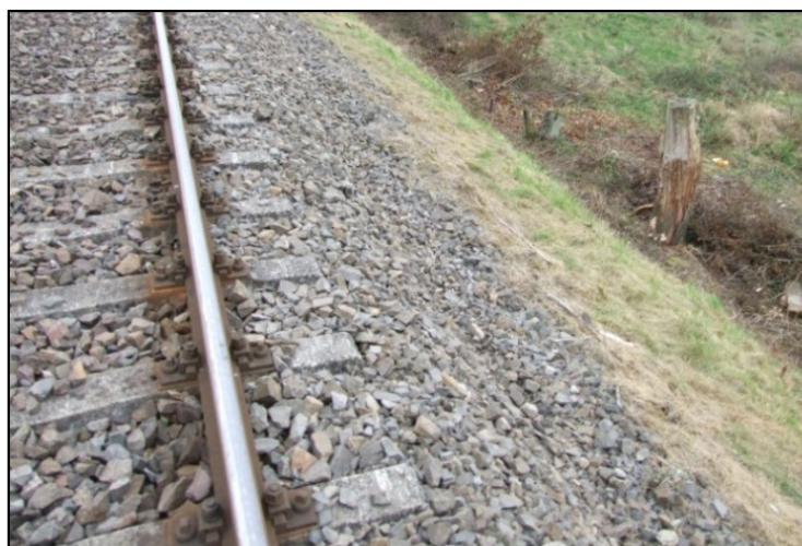
Rys. 13. Brak odpowiedniej szerokości ławy torowiska oraz brak zasypania za czołem podkładów
