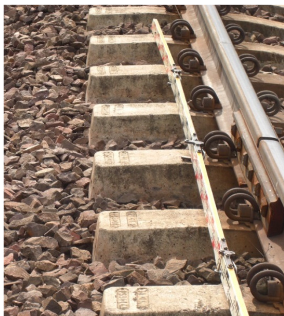
Rys. 3. Nieobsypane czoła podkładów
