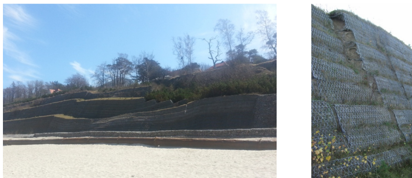
Rys. 20. Zdeformowana konstrukcja z gruntu zbrojonego zabezpieczająca klif w rejonie „Bałtyku” u podnóża zdeformowana opaska brzegowa z gabionów (Fot. Z. Sikora, 2014 r.)
