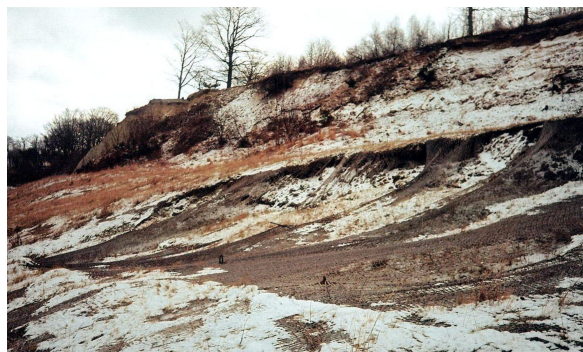
Rys. 18. Zniszczone zabezpieczenie biotechniczne centralnego fragmentu zbocza klifowego. Widoczna siatka wzmacniająca (Fot. W. Subotowicz, 13.02.2009 r.)
