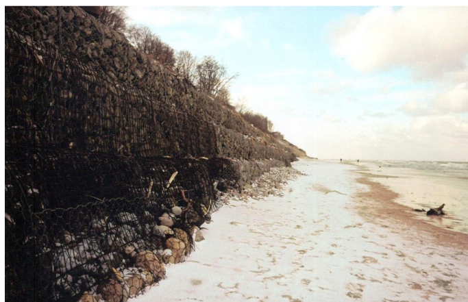
Rys. 10. Gabiony reperowane za pomocą prętów zbrojeniowych w rejonie „Horyzontu” (Fot. W. Subotowicz 13.02.2009 r.)
