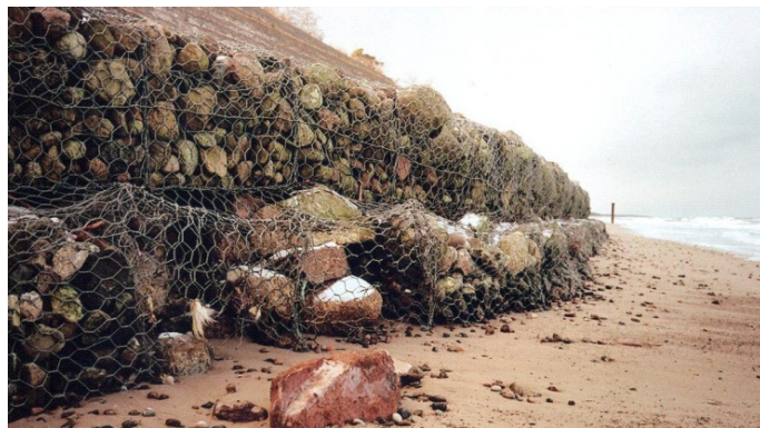
Rys. 9. Zniszczone gabiony w rejonie ośrodka wypoczynkowego „Bałtyk” (fot. W. Subotowicz 13.02.2009 r.)
