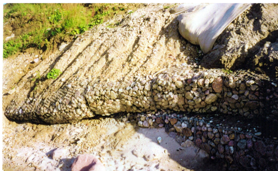
Rys. 14. Zniszczone gabiony opaski brzegowej w rejonie „Bałtyku” (Fot. W. Subotowicz, 2.09.1998 r.)
