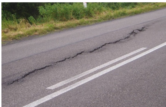
Rys. 3. Pęknięcie i deformacja nawierzchni [zdjęcie ZZDW Koszalin]
