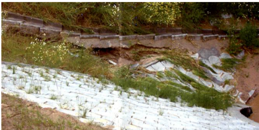
Rys. 5. Uszkodzenie korpusu w wyniku spływu skoncentrowanego wody opadowej ze zlewni B
