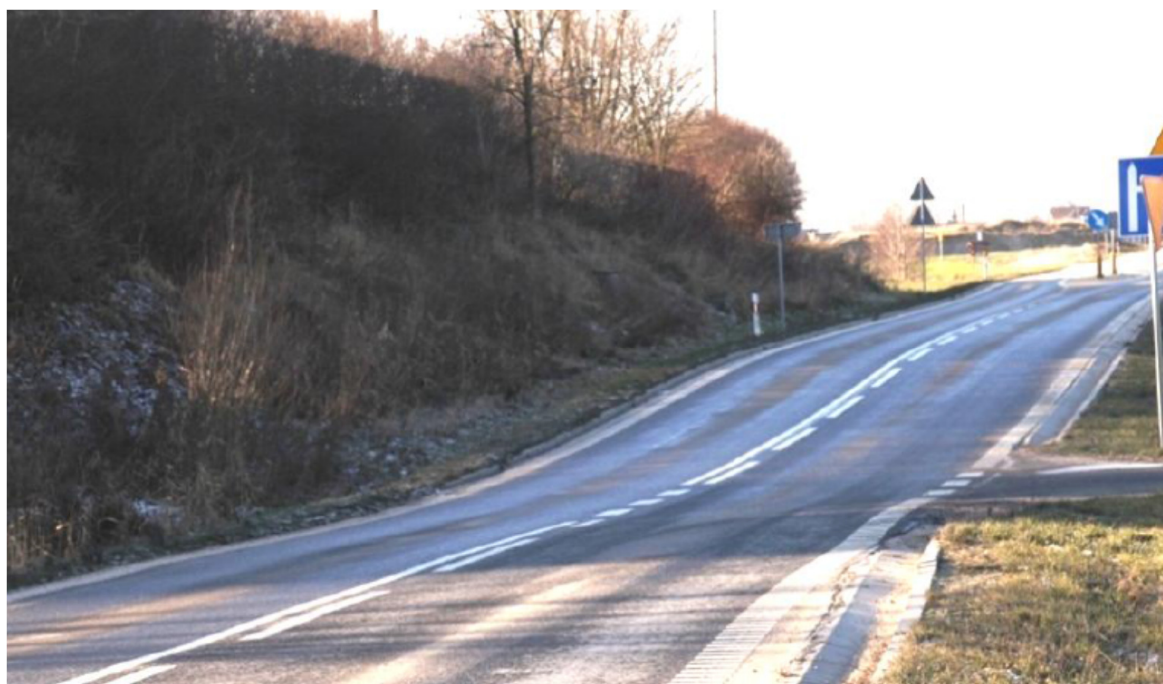
Rys. 6. Przykład obniżenia drogi, zapadliska o małym promieniu w strefie zalegania około 11 m gruntów organicznych.
