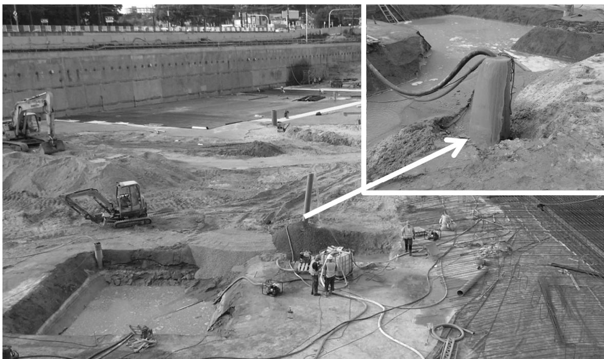
Rys. 5. Miejsce awarii (przegłębienie w wykopie), jako szczegół-skanalizowanie wypływu w rurze [4]
