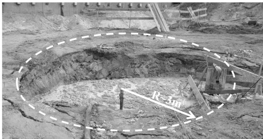
Rys. 3. Miejsce awarii – widoczne zapadlisko wywołane przebicciem hydraulicznym wokół piezometru [4]
