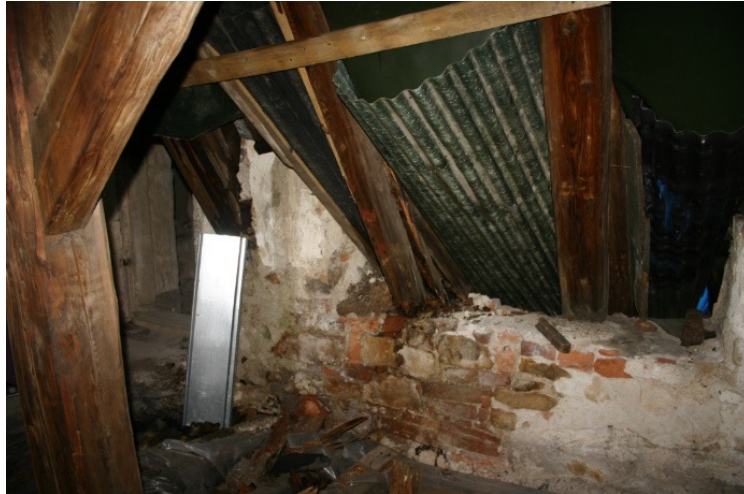
Rys. 2. Widok uszkodzeń krokwi w wyniku zawilgocenia oraz korozji biologicznej
