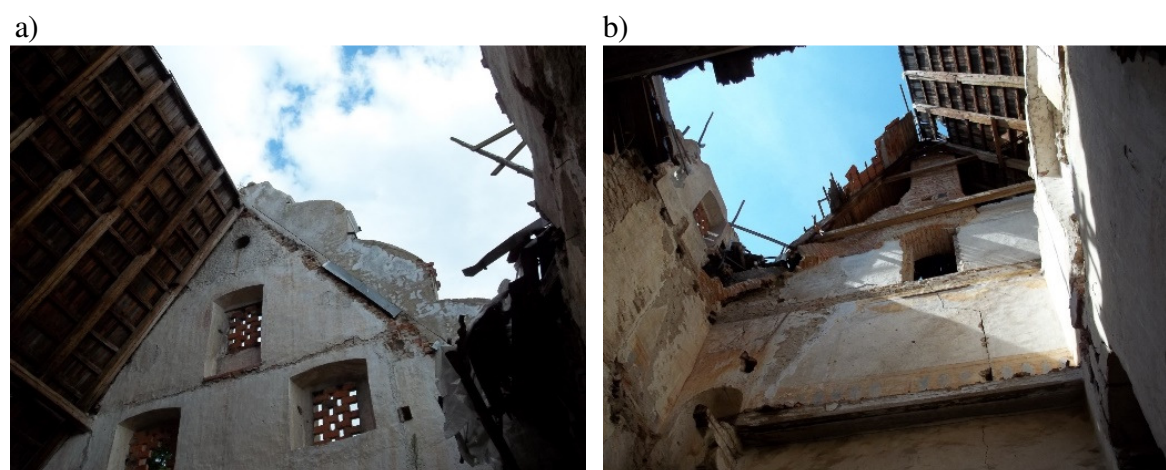
Rys. 6. Widok zniszczeń w centralnej części budynku wywołane zawaleniem się dachu
