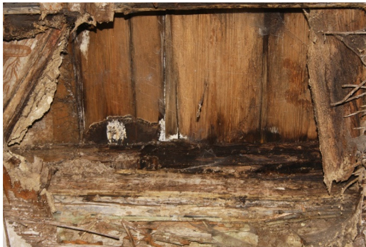
Rys. 3. Widok uszkodzeń wywołanych zawilgoceniem oraz działaniem grzyba domowego białego
