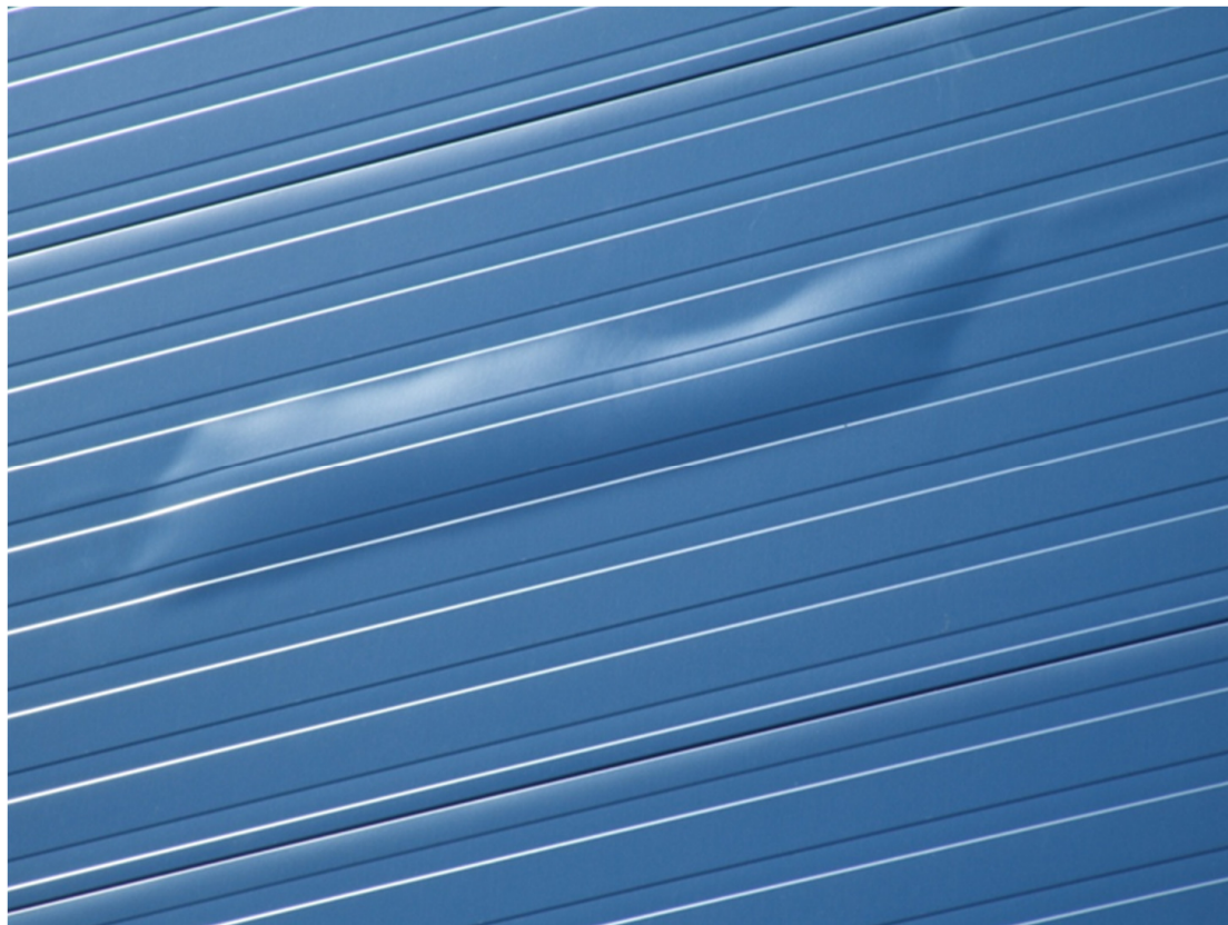
Rys. 1. Uszkodzenia płyty obudowy
