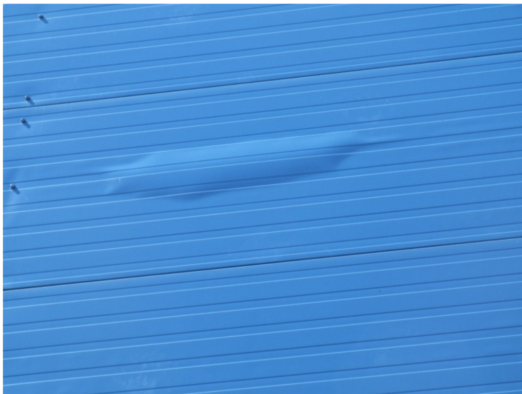
Rys. 3. Uszkodzenia płyty obudowy
