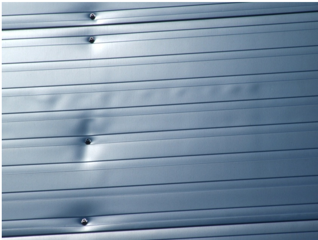
Rys. 2. Uszkodzenia płyty obudowy
