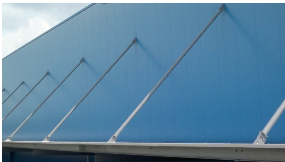
Rys. 8. Widok elewacji w osi J przed wykonaniem naprawy
