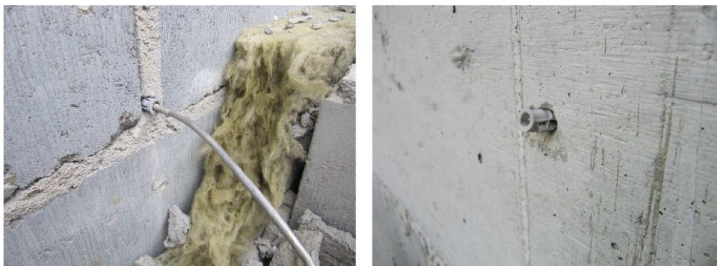
Rys. 10. Wady osadzenia kołków w murze
