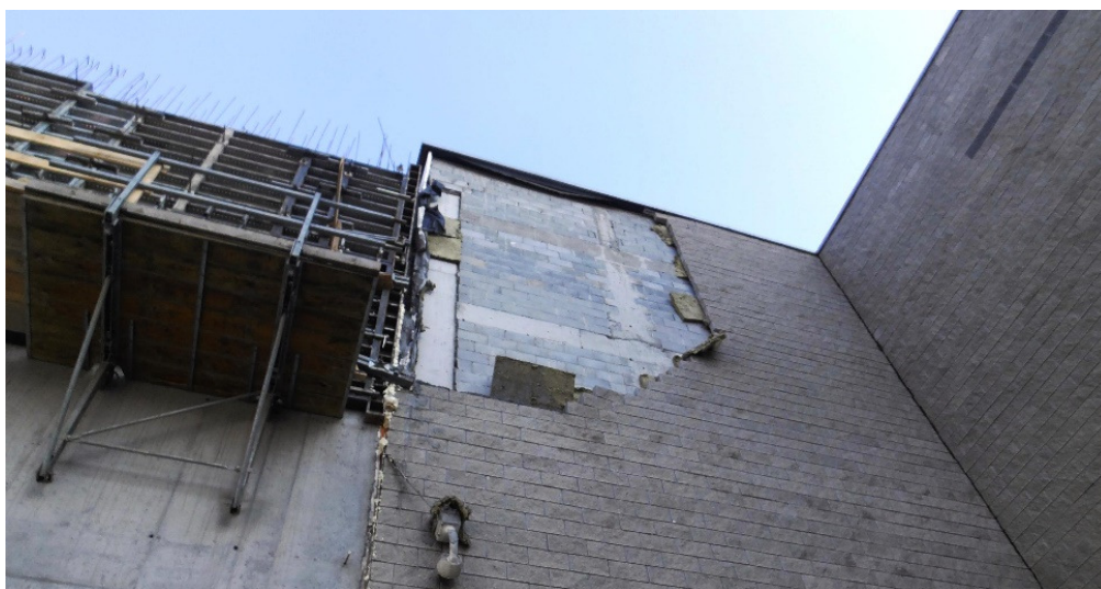
Rys. 1. Widok elewacji po awarii
