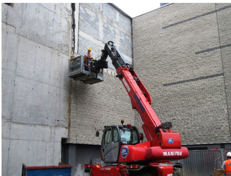
Rys. 3. Widok ściany po rozebraniu zagrażającej odpadnięciem części elewacji
