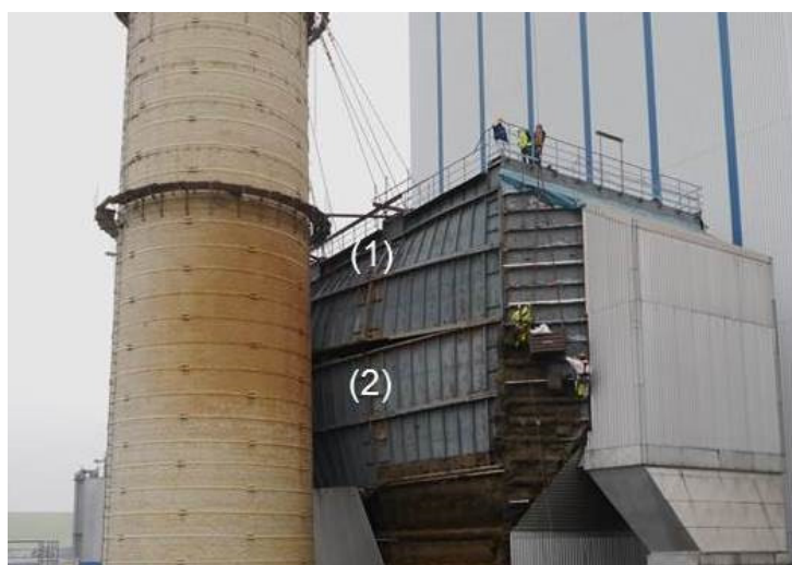
Rys. 1.3. Utrata nośności ściany kasetonowej: (1) Wyrzuczenie poziomych żebier usztywniających, (2) Rozerwanie pionowych żebier nośnych
