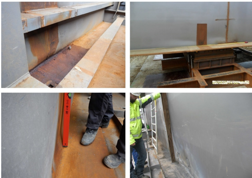
Rys. 4. Plastyczne wyboczenie środników stalowej skrzynki mostu w Kamieniu podczas nasuwania od strony Iłży
