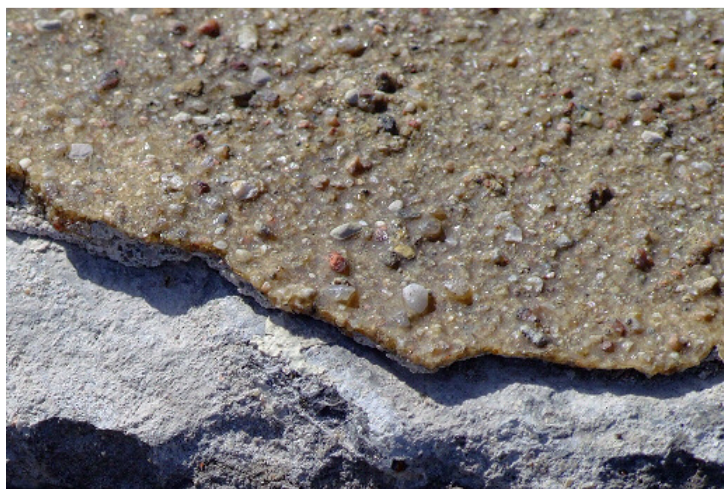
Rys. 3. Rozwarstwienie połączenia pomiędzy betonem nawierzchni lotniskowej a warstwą naprawczą, wykonaną z żywicy epoksydowej z wypełniaczem piaskowym – wynik odkształceń termicznych [6]
