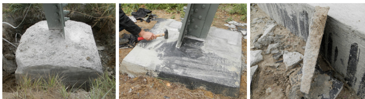
Rys. 2. Górna powierzchnia części fundamentu słupa energetycznego: zdegradowana powierzchnia przed naprawą (po lewej), po naprawie sztywnym betonem polimerowym (w środku) oraz warstwa naprawcza odspojona od podłoża betonowego w wyniku działania temperatury i skurczu (po prawej)
