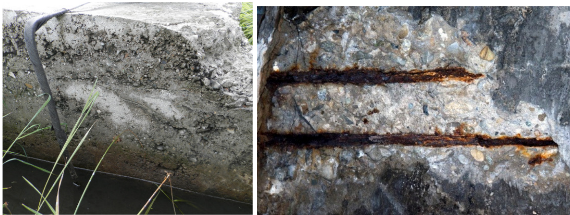
Rys. 1. Przykładowe uszkodzenia konstrukcji betonowych narażonych na oddziaływania chemiczne (karbonatyzacja betonu i korozja stali zbrojeniowej) w zmiennych warunkach środowiskowych
