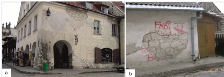
Rys. 8. Przykłady łuszczenia tynków na kamiennych murach zabytkowych kamienic związane z tym akty wandalizmu
