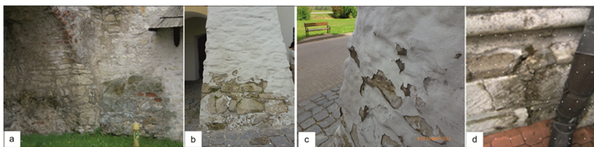
Rys. 7. a) Zawilgocone i przebarwione fragmenty murów Zamku b) i c) pokrywanie tynkiem odnowionych powierzchni murów (dawny spichlerz zbożowy), d) brak drenażu.
