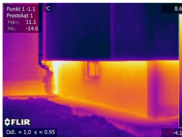
Rys. 2. Zdjęcie wykonane kamerą termowizyjną. Widoczna różnica w rozkładzie temperatur na ścianach piwnic i kondygnacji nadziemnych. Rozkład temperatur na ścianach piwnic może świadczyć o nieciągłościach w ich strukturze
