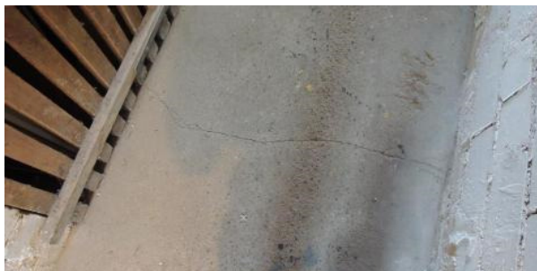
Rys. 5. Spękania posadzki w piwnicy
