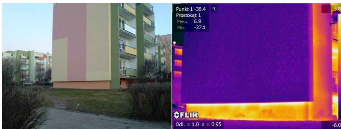
Rys. 1. Zdjęcie wykonane kamerą termowizyjną i aparatem fotograficznym. Widoczna różnica w rozkładzie temperatur na ścianach piwnic i kondygnacji nadziemnych. Rozkład temperatur na ścianach piwnic może świadczyć o nieciągłościach w ich strukturze
