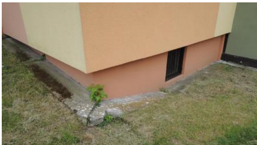
Rys. 4. Uszkodzenia opaski betonowej
