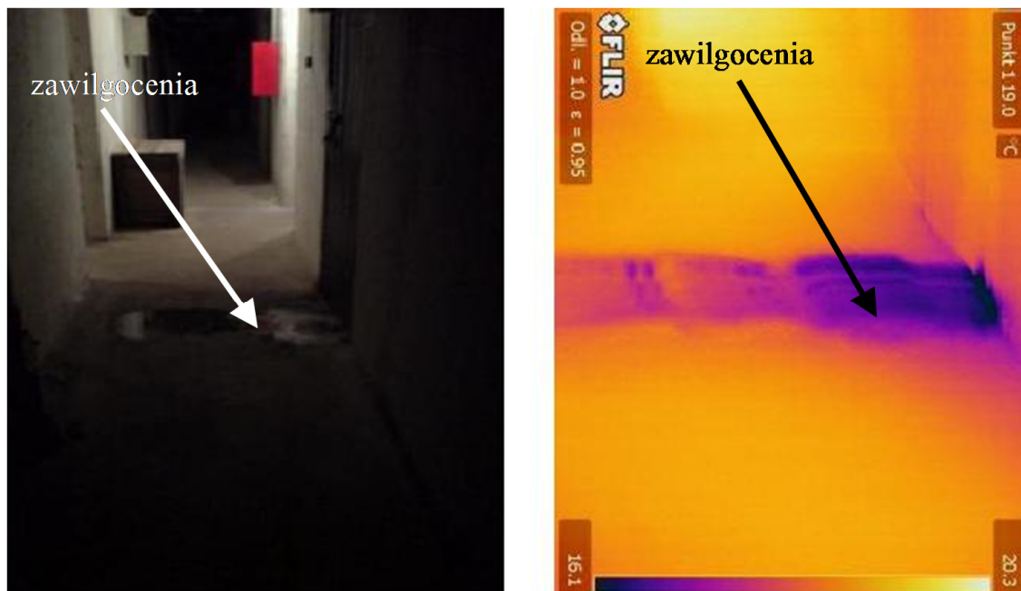
Rys. 3. Zdjęcie wykonane kamerą termowizyjną i aparatem fotograficznym. Widoczne zawilgocenia w piwnicy budynku, na posadzce
