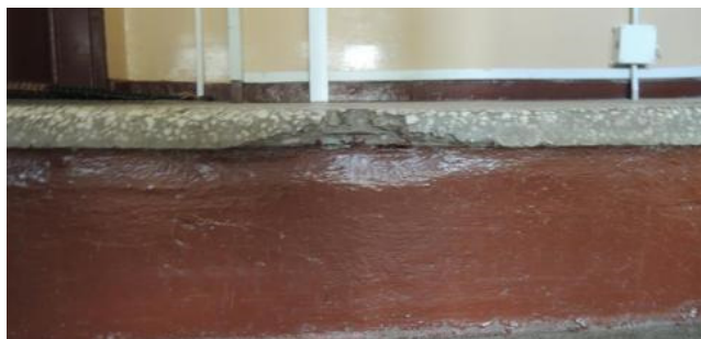
Rys. 8. Uszkodzenia stopni w prefabrykowanych schodach prowadzących do piwnicy
