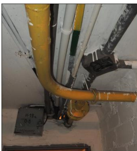
Rys. 6. Niezabezpieczone kable instalacji elektrycznej w piwnicy
