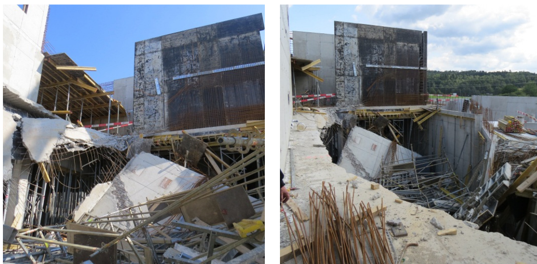
Rys. 4. Widoki zniszczonej konstrukcji
