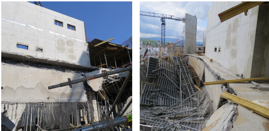
Rys. 5. Kolejne widoki ilustrujące stan konstrukcji po awarii
