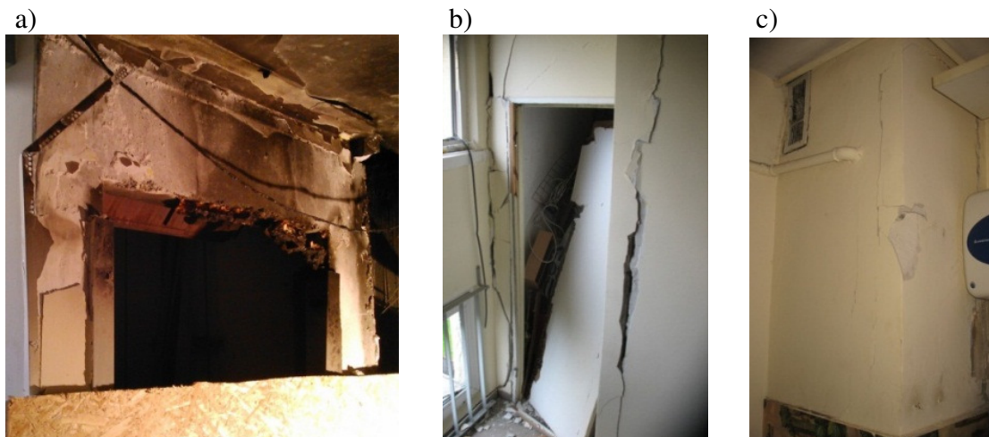
Rys. 10. Uszkodzenia: a) drzwi szybu na III p., b) ścianek działowych, c) przewodów kominowych
