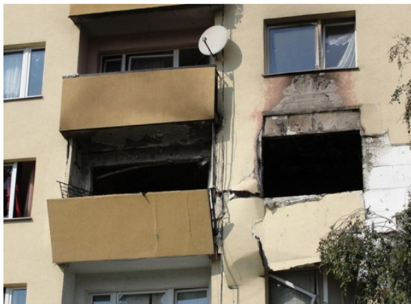
Rys. 5. Widok na zniszczone ściany osłonowe ZWO w mieszkaniu M2
