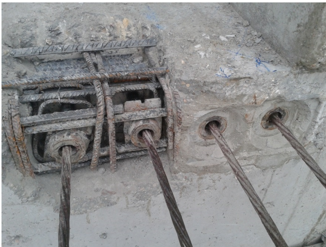
Rys. 2. Strefa zakotwienia pozbawiona nienośnego betonu
