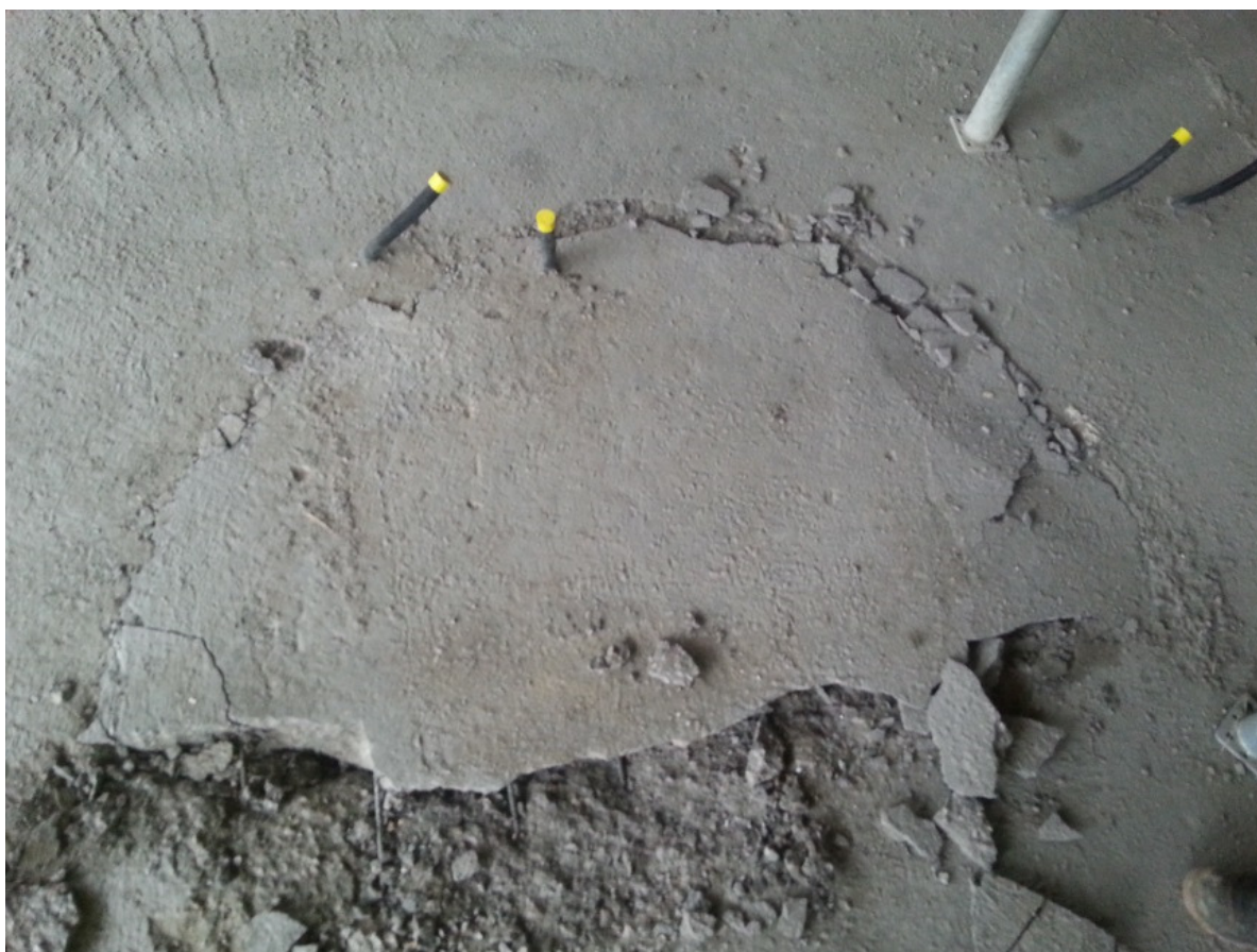
Rys. 5. Miejsce awarii – odspojony beton w strefie zakotwień biernych
