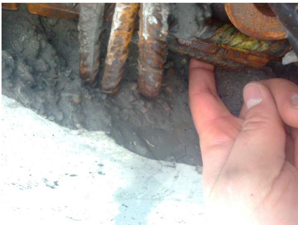
Rys. 4. Miejsce potencjalnej awarii – niewłaściwie ułożona mieszanka betonowa; strefa zakotwienia jest niedobetonowana, zbrojenie które powinno być w betonie pozostało nieobetonowane
