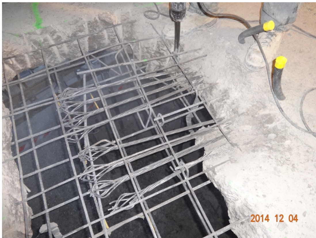
Rys. 6. Strefa awarii po usunięciu betonu – brak pionowych elementów zbrojenia (tzw. „szpilek”)
