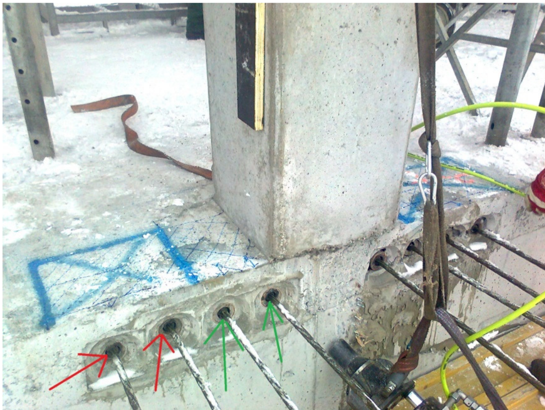
Rys. 1. Miejsce awarii: lokalizacja poszczególnych kabli: czerwone strzałki wskazują zakotwienia do wykucia i wymiany; zielone strzałki wskazują kable do odprężenia
