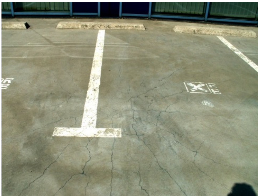
Rys. 4. Rysy promieniste widoczne nad słupem
