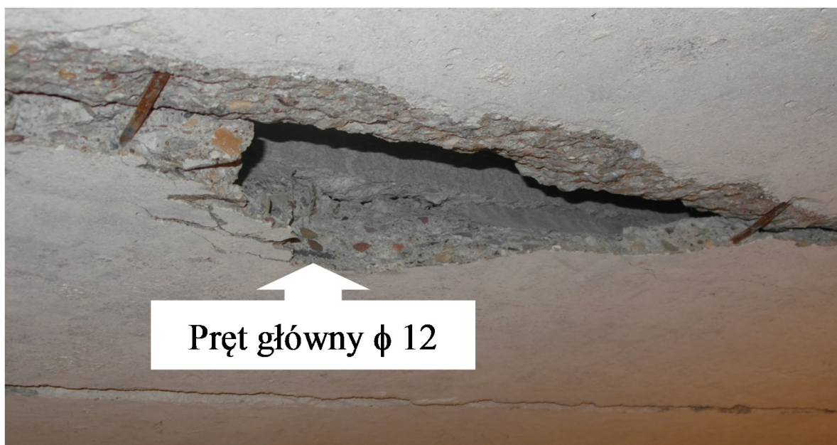
Rys. 3. Widok odkrywki do pręta głównego uszkodzonej płyty A
