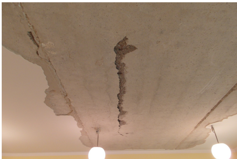
Rys. 1. Zarysowanie podłużne na dolnej powierzchni jednej uszkodzonych płyt
