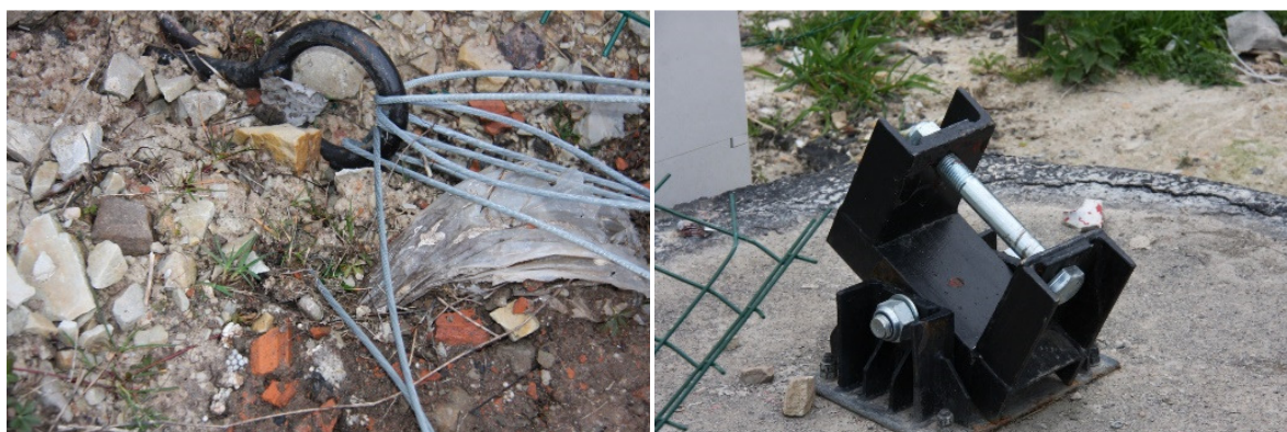
Rys. 6. Widok stanu lin odciegów w zakotwieniu po awarii
