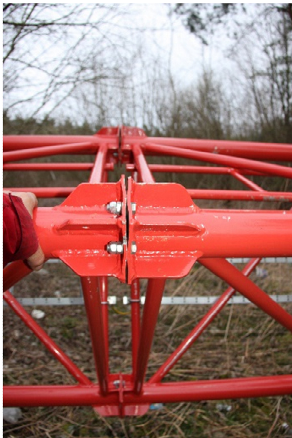
Rys. 2. Widok uszkodzonych połączeń kołnierzowych
