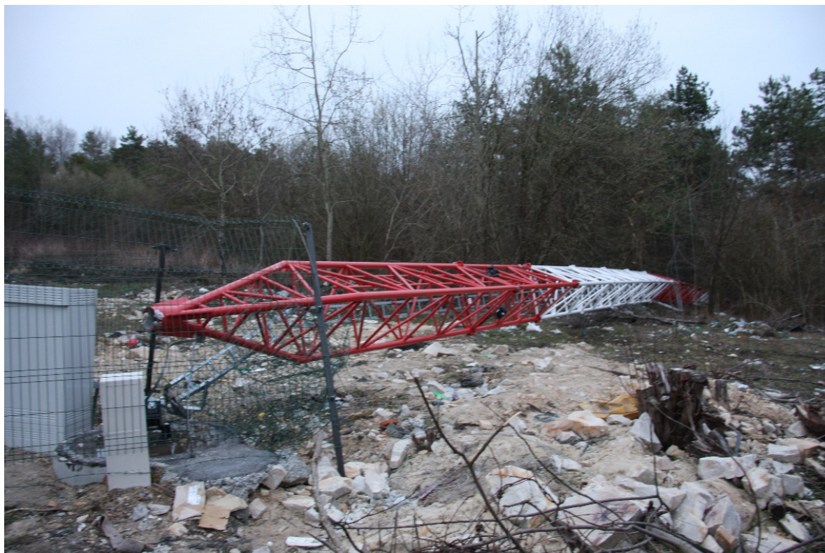
Rys. 1. Widok aluminiowego masztu telekomunikacyjnego M100F o wysokości 80,0 m, tuż po katastrofie
