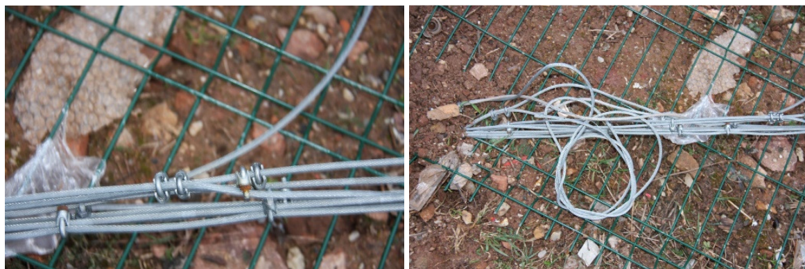
Rys. 5. Widok stanu lin odciegów w zakotwieniu po awarii
