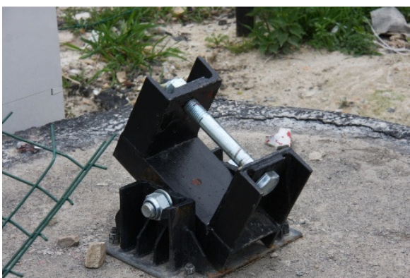
Rys. 7. Widok stanu podpory masztu po awarii
