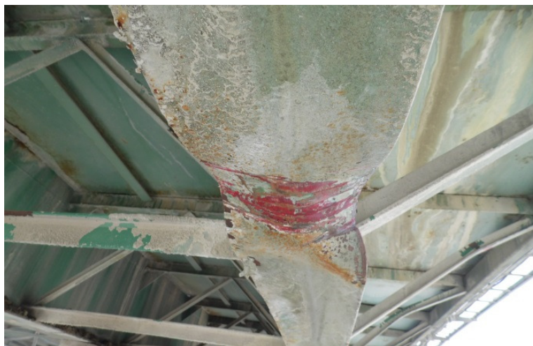
Rys. 2. Zdeformowany pas dolny belki zachodniej (uderzenie lewą burtą skrzyni ładunkowej)
