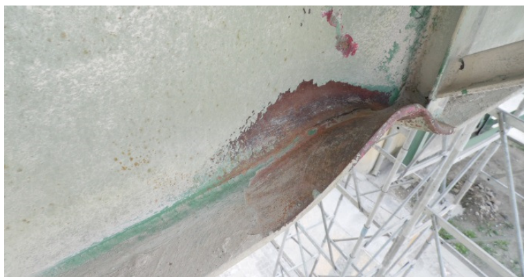
Rys. 3. Jak wyżej, widoczna pęknięta spoina i uplastyczniony środek
