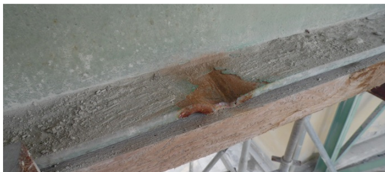
Rys. 4. Zdeformowany i pęknięty pas dolny belki zachodniej (uderzenie prawą burtą)
