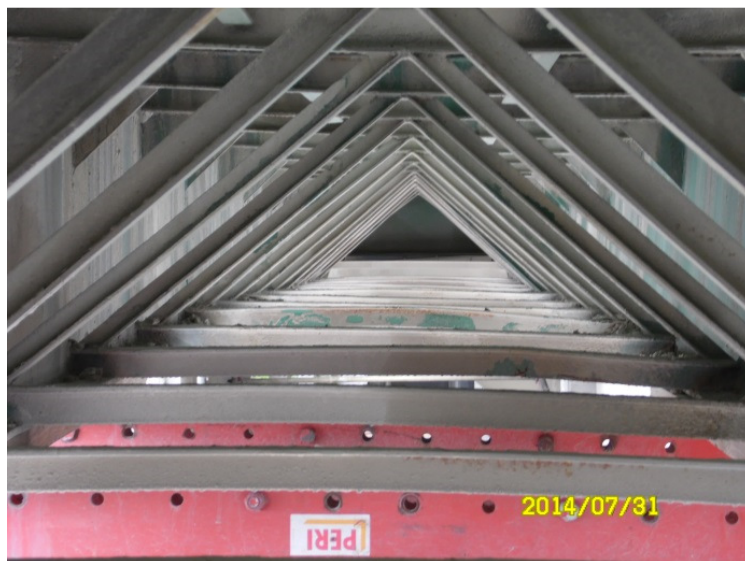
Rys. 5. Trwałe odkształcenia elementów poprzecznych łączących belki główne
