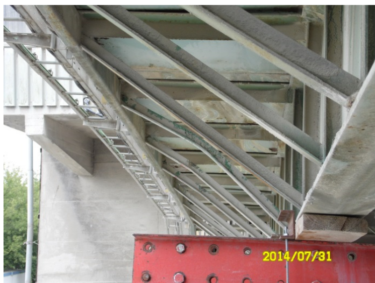
Rys. 6. Trwałe odkształcenia zastrzałów wspierających pomost obsługowy po stronie zachodniej
