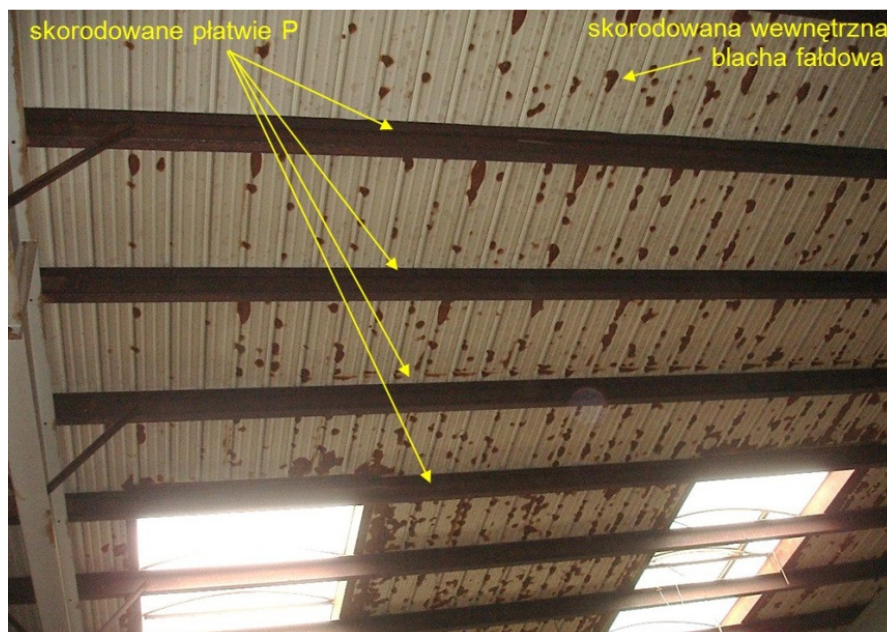
Rys. 3. Widok skorodowanych płatwi P oraz blach fałdowych
