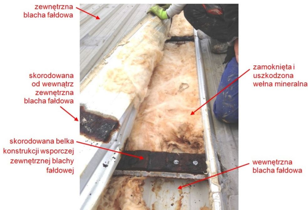
Rys. 5. Widok skorodowanej obudowy dachu w „odkrywce”
