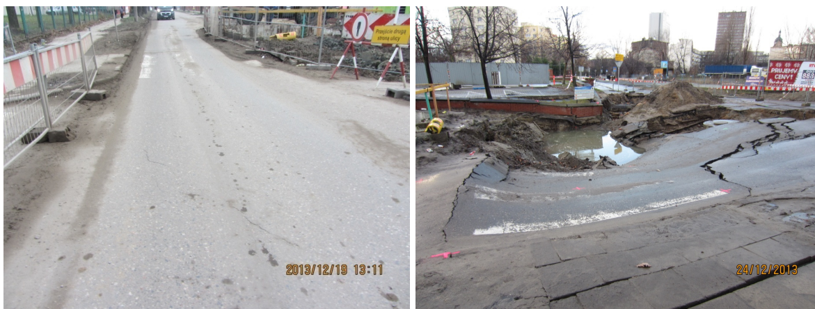
Rys. 6. (a) Pierwsze spękania nawierzchni jezdni, (b) Ustabilizowane zapadlisko [5]
