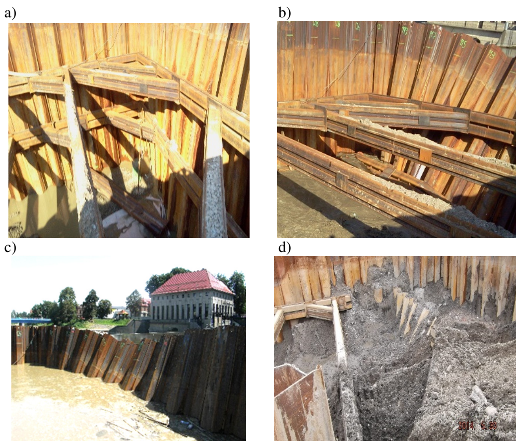
Rys. 2. Etapy rozwoju awarii grodzy S-8: a) rozparcie poziomymi zastrzałami, b, c) zapełnianie wykopu nawodnionym gruntem i deformacja grodzy S-8, d) stan po awarii w nowo ubezpieczonym wykopie z odciętą zdeformowaną ścianką.
