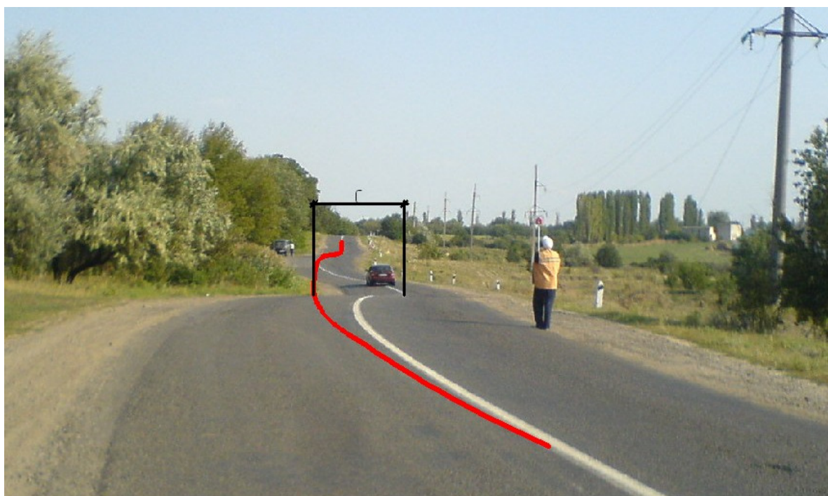
Rys. 2. Poziome przemieszczenie odcinka drogi „Nikolaev – Domanevka – Berezki” km 168 – km 171; na rysunku oznaczono zdeformowaną oś drogi i wielkość przemieszczenia poziomego
