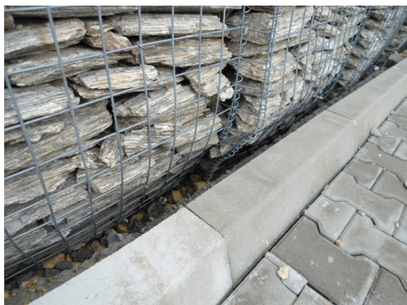
Rys. 2. Widok uszkodzeń w dolnej części konstrukcji
