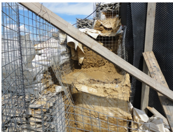
Rys. 3. Rejon największego uszkodzenia ściany z gabionów
