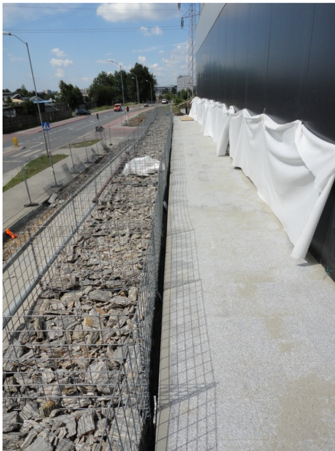
Rys. 4. Widok odchylonej konstrukcji z koszy gabionowych wzdłuż budynku
