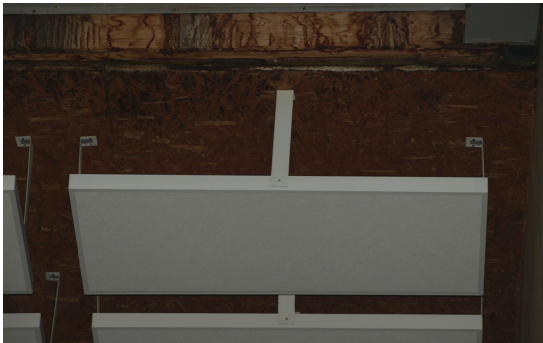
Rys. 7. Elementy sufitu podwieszonego z płyt ECOPHON mocowane wkrętami ocynkowanymi do zawilgoconych płyt OSB-4. Poluzowane mocowania płyt sufitu
