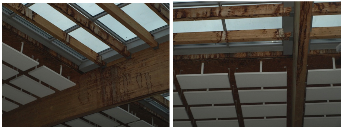
Rys. 4. Zacieki i przebarwienia na dźwigarach i płatwiach. Widoczne elementy sufitu podwieszonego mocowanego do płyt OSB-4
