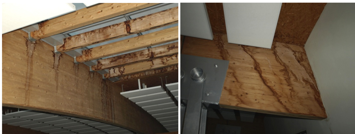
Rys. 5. Zacieki i przebarwienia na dźwigarach
