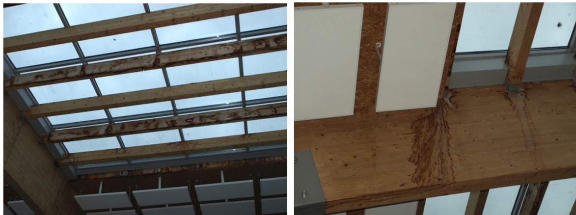
Rys. 3. Zacieki i przebarwienia na dźwigarach i płatwiach
