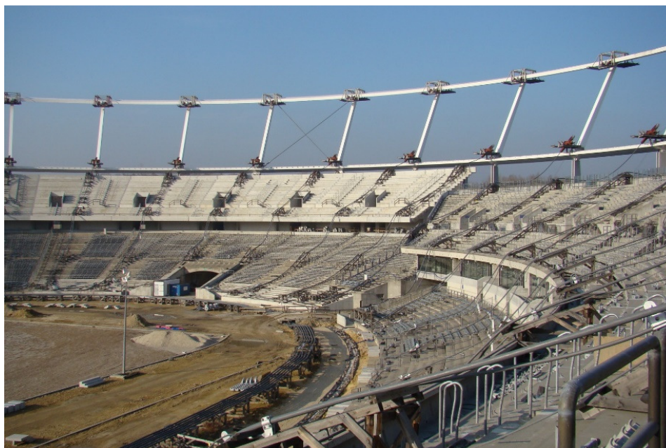
Rys. 1. Zaawansowanie budowy do awarii systemu linowego zadaszania (stan w 2012 r.)
