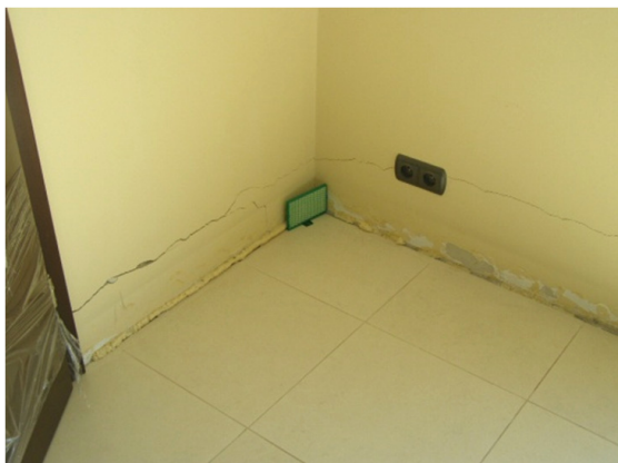
Rys. 2. Poziome zarysowania ścian piętra
