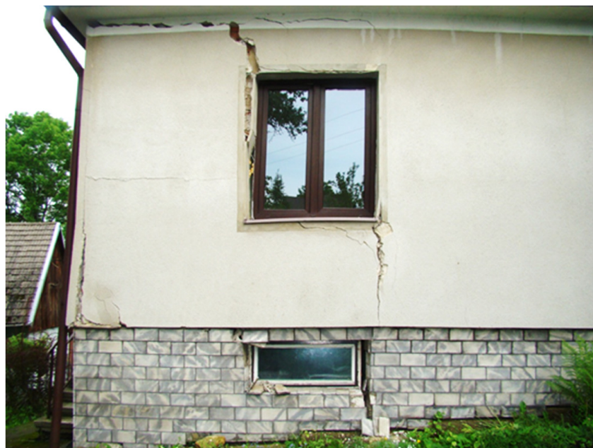
Rys. 3. Zniszczenie budynku mieszkalnego powstałe w wyniku osuwiska (powiat brzeski, woj. małopolskie, 2010)
