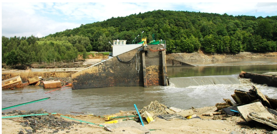
Rys. 9. Widok na zapórę w Niedowie po katastrofie (fot.: Jerzy Machajski, Politechnika Wrocławska,)
