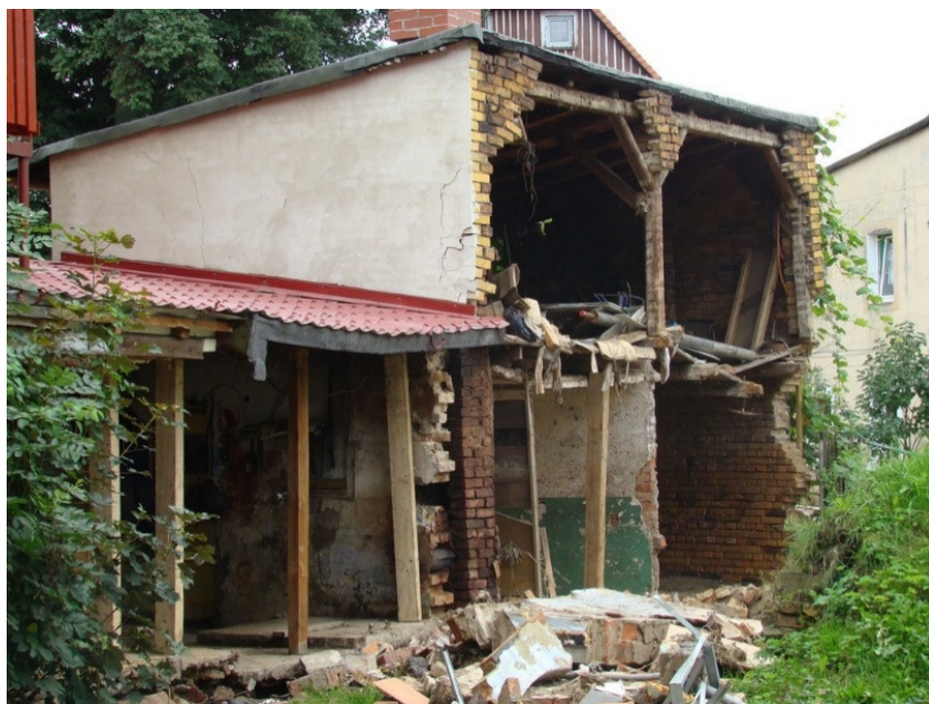
Rys. 1. Zniszczenie budynku mieszkalnego powstałe po powodzi (Bogatynia, woj. dolnośląskie, 2010)
