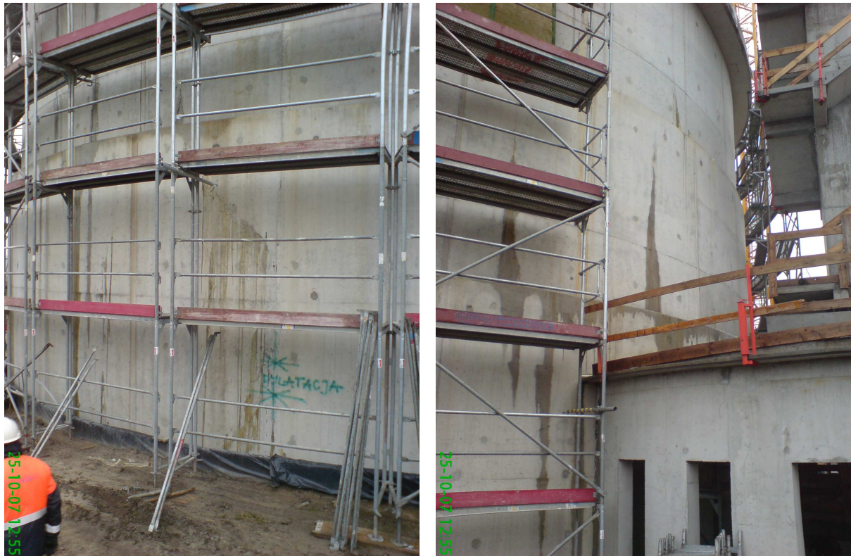
Rys. 2. Widok zarysowań płaszczu zbiornika w trakcie prac iniekcyjnych
