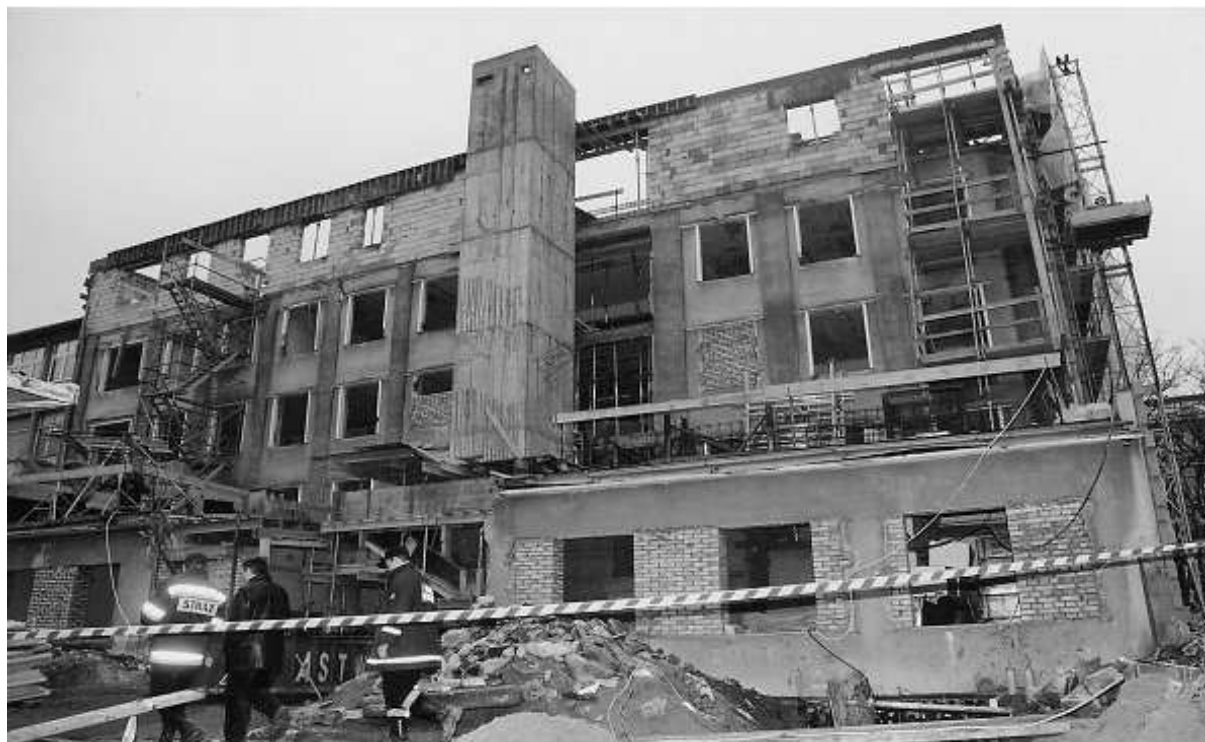
Rys. 1. Elewacja tylna przedmiotowego budynku w dniu katastrofy budowlanej
