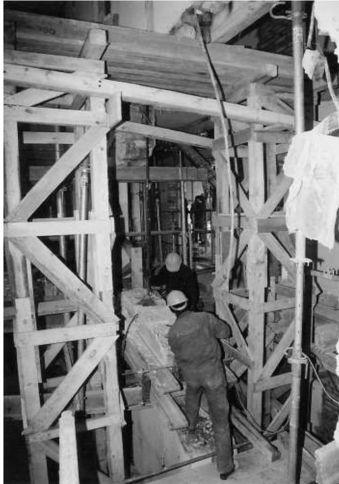
Rys. 5. Fragment konstrukcji wsporczych podpierających ścianę konstrukcyjną II piętra obciążoną trzema kondygnacjami. Widok w trakcie rozbiórki „bloku murowanego” ze ściany środkowej na I piętrze
