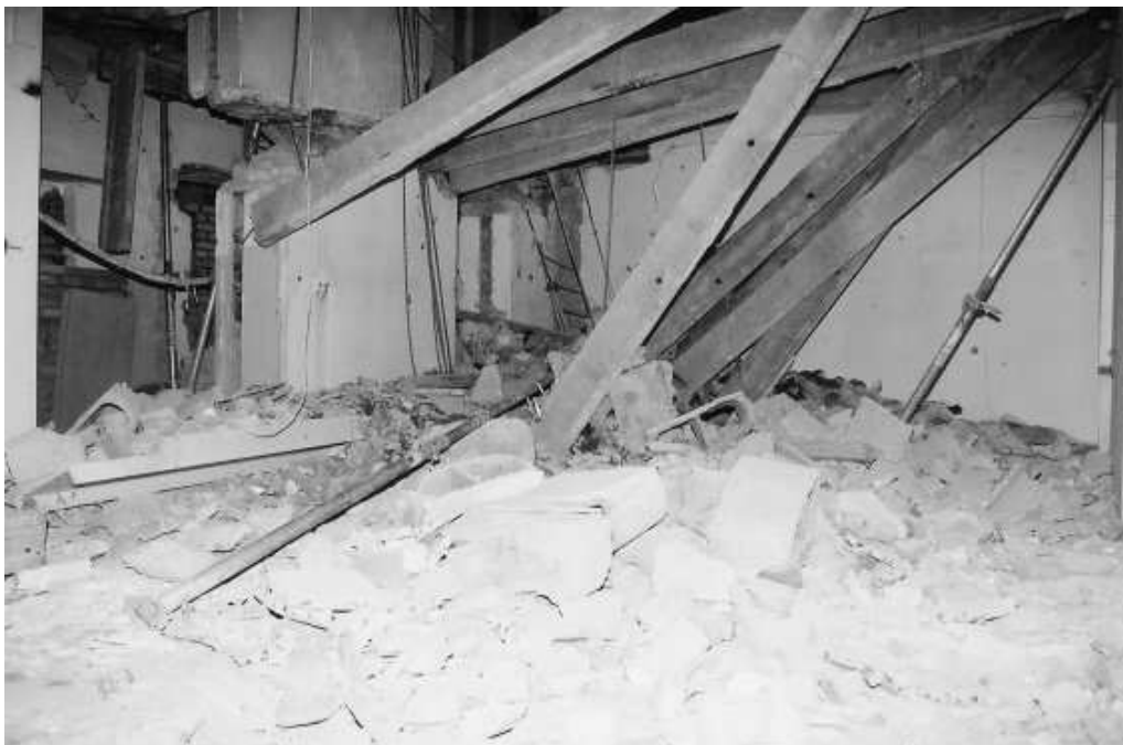
Rys. 3. Widok uszkodzonego stropu nad parterem i zniszczonych pustaków DMS
