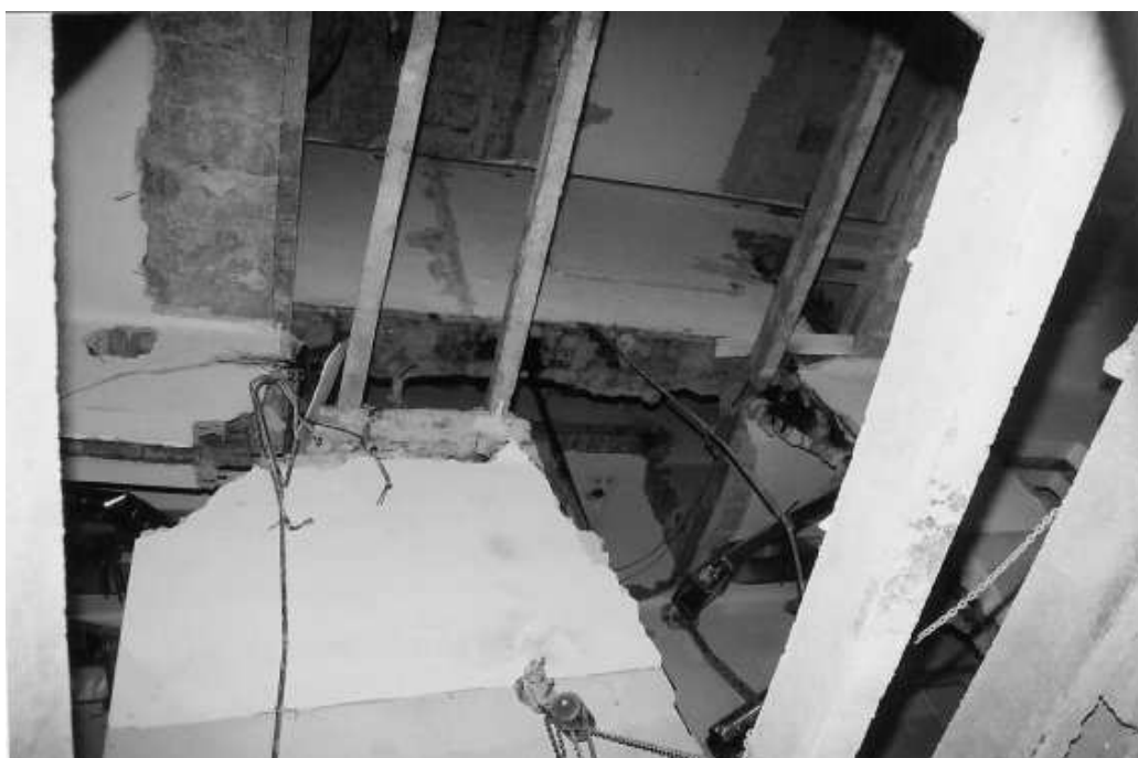
Rys. 4. Widok z poziomu stropu nad parterem. Widoczna „zawieszona” w powietrzu ściana II piętra, konstrukcyjna, środkowa (obciążona dodatkowo dwiema kondygnacjami; IV i V kondygnacją). Brak wieńca żelbetowego
