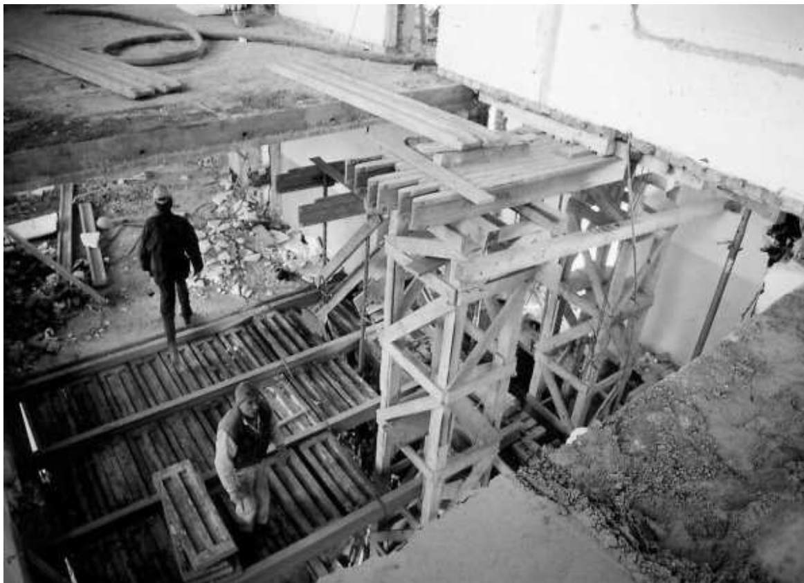
Rys. 6. Widok na konstrukcje wsporcze wykonane z ze słupów kratownicowych drewnianych zapewniających bezpieczne podparcie ściany na II piętrze obciążonej dodatkowo dwiema kondygnacjami. Widoczny jest fragment nowego stropu z płytami WPS
