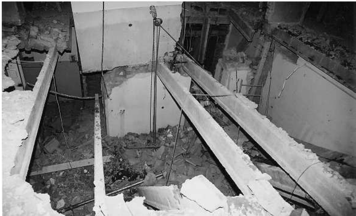
Rys. 2. Widok z góry – z pierwszego piętra – na miejsce katastrofy
