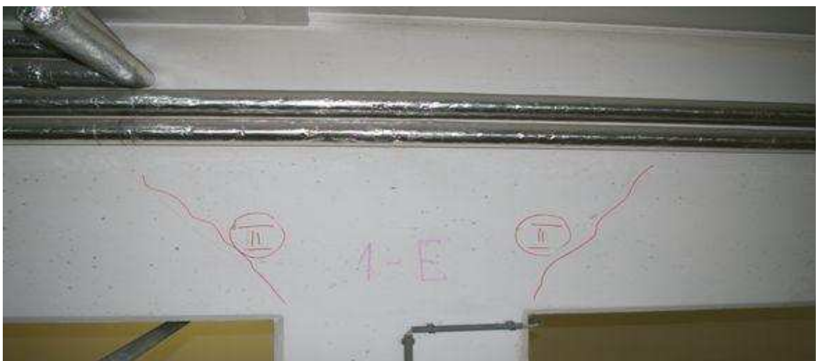
Rys. 2. Rysy ukośne w połączeniu podciagu ze słupami
