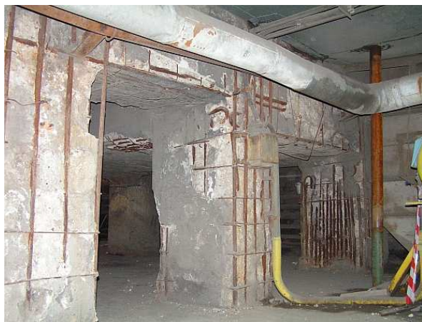
Rys. 2. Słupy konstrukcji wsporczej pod kotły – ubytki otuliny na znacznych powierzchniach, brak strzemion, korozja odsłoniętych prętów zbrojenia
