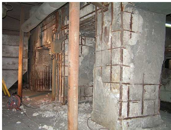
Rys. 3. Uszkodzenia bocznych powierzchni słupów oraz rygli ram – słaba przyczepność betonowej otuliny, nieprawidłowe rozstawy prętów w słupach
