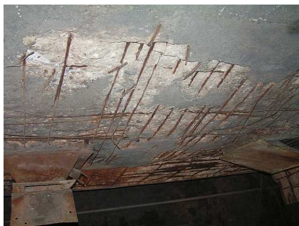
Rys. 7. Dolna powierzchnia konstrukcji wsporczej kotła przy lejach do odprowadzania popiołu – odkryte zbrojenie, korozja stalowych elementów
