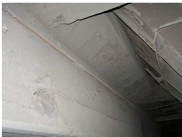
Rys. 6. Boczna powierzchnia wewnętrznego rygla – zarysowania otuliny w miejscach strzemion, lokalne ubytki i wykruszenia betonu
