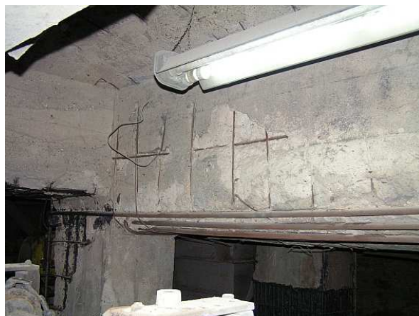
Rys. 5. Boczna powierzchnia rygla podłużnego – przerwane i dość rzadko rozmieszczone strzemiona
