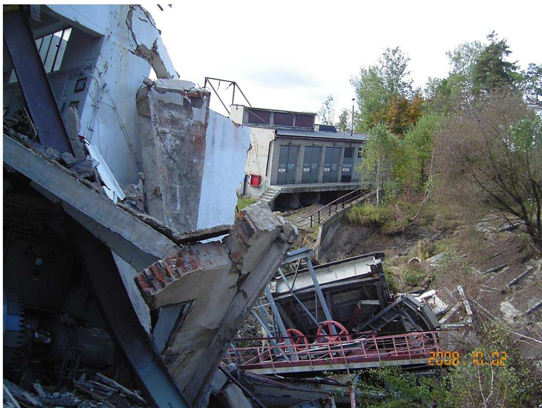
Fot. 2. Widok uszkodzonych obiektów
