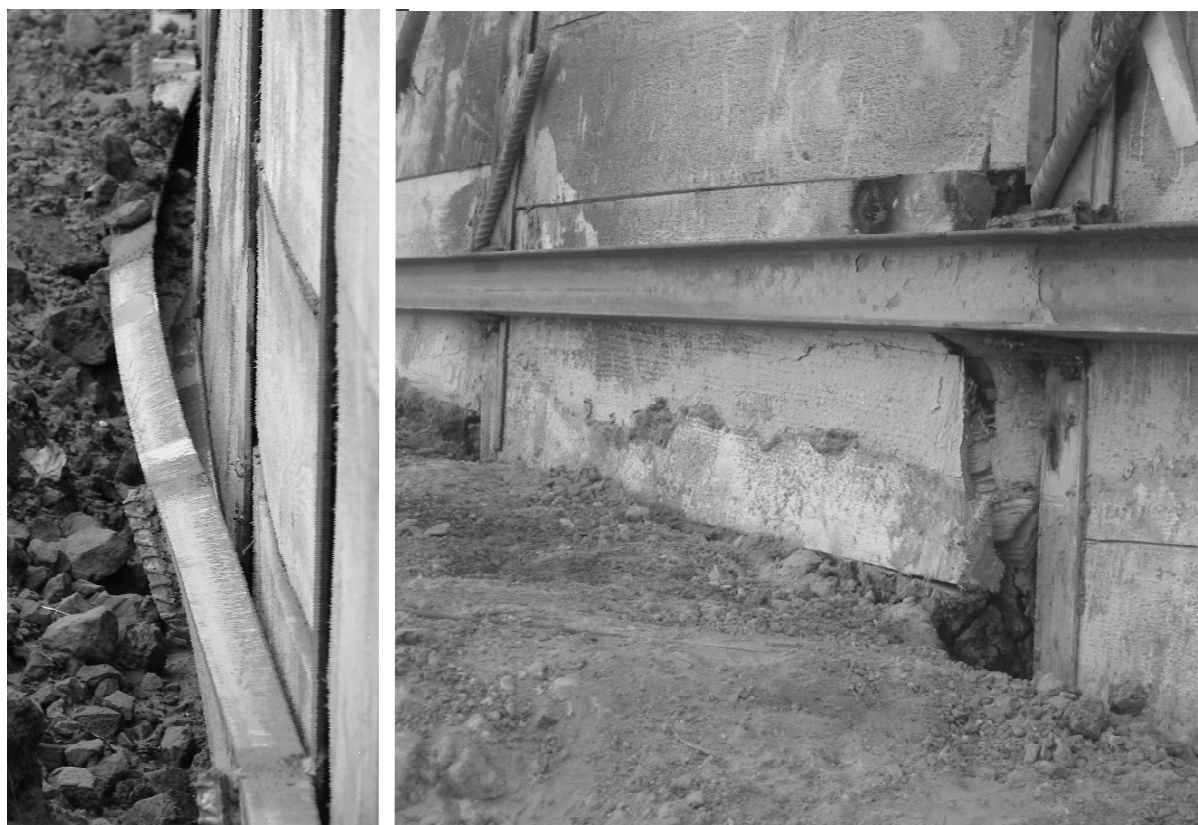
Rys. 1. Konstrukcja ściany berlińskiej po awarii. Różne sposoby mocowania oczepu i gwoździ
